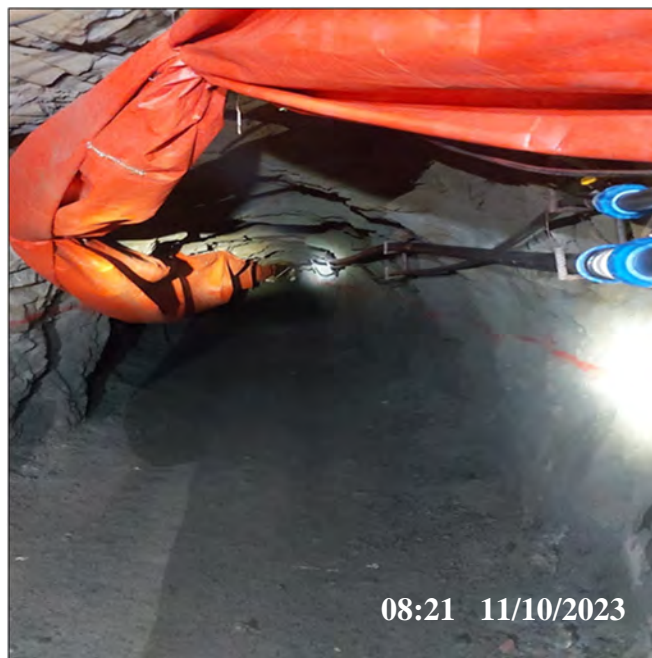
Figura 62. Manga de ventilación y conexión de tubería secundaria de agua y aire comprimido
