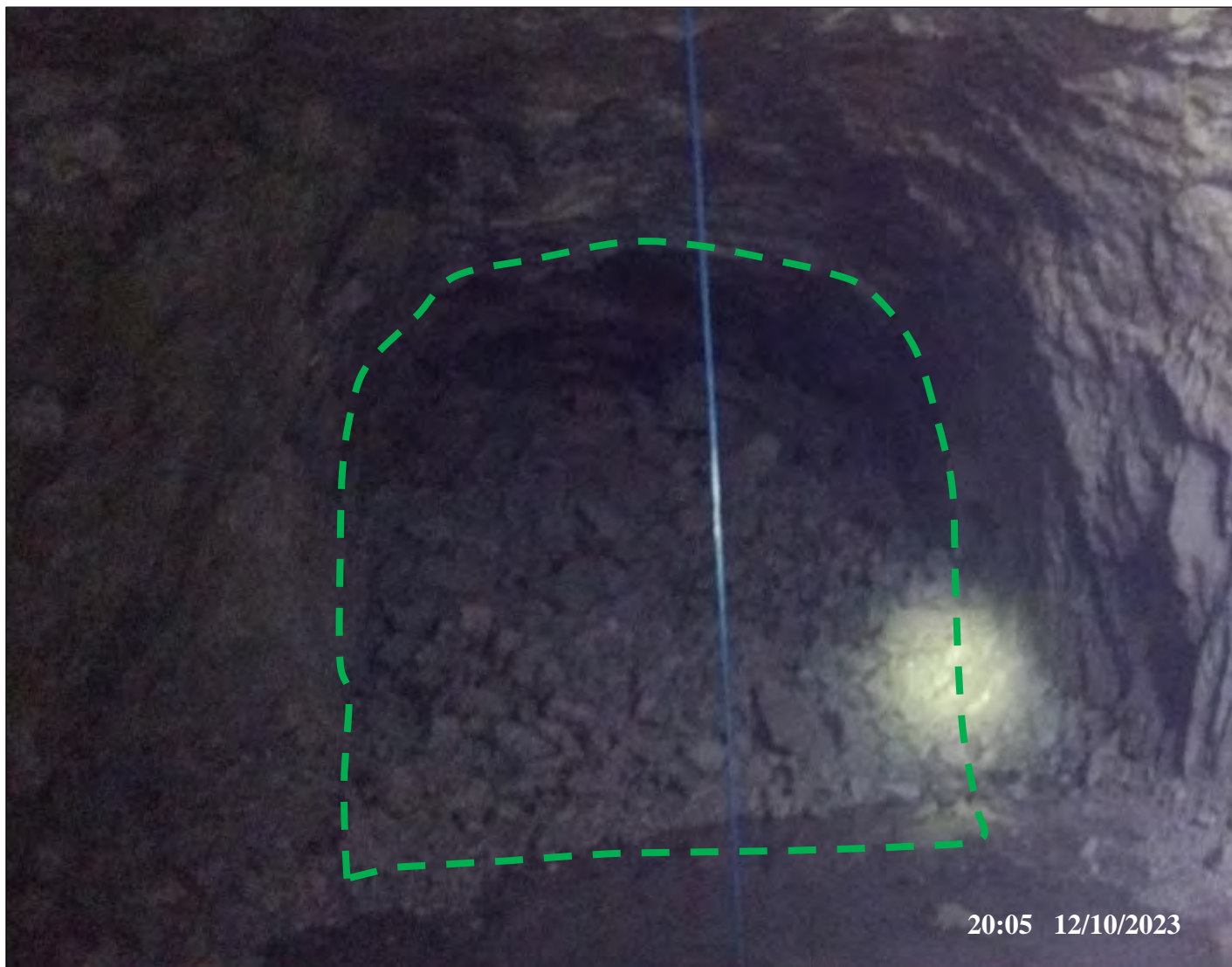
Figura 50. Disparo propuesto de la Gl 755 SO en nivel 1100, fragmentación y sección uniforme
