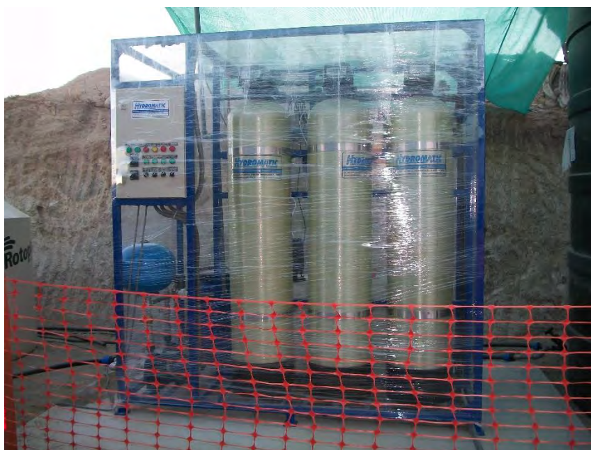
Figura 2 Sistema de filtros, usado para la potabilización de agua.
