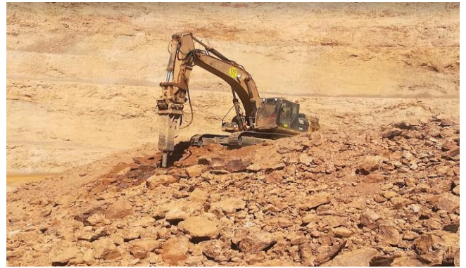
Fotografía N° 15: Reducción de diámetro de bolonerías
