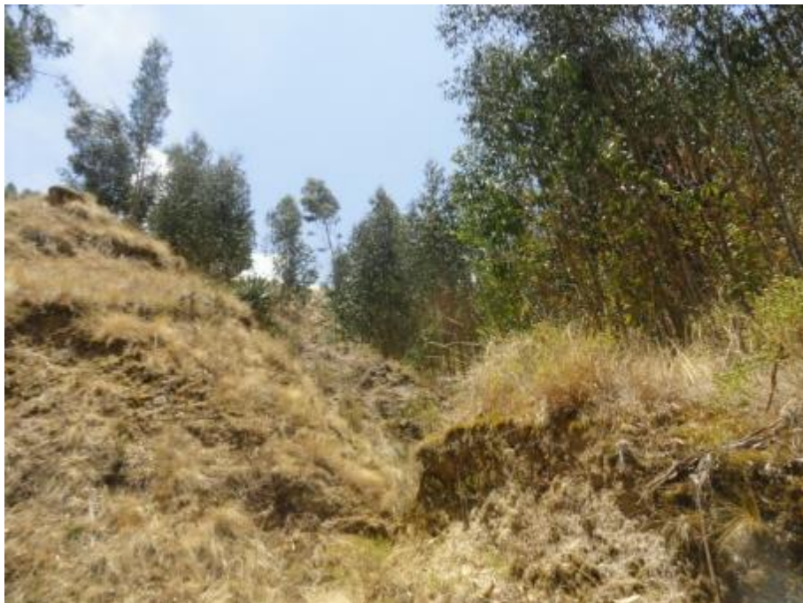
Figura 38: Canal artesanal en el que produce infiltración y saturación de talud para su activación del deslizamiento
