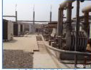
Ampliación de la Estación de Compensación
