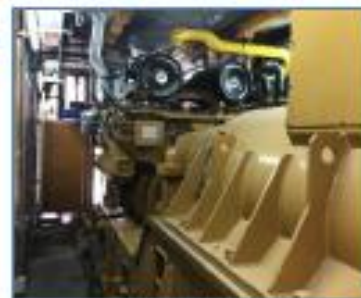
Vista del grupo de generación
