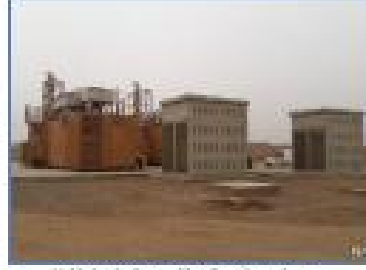
Unidades de Generación y Transformación
