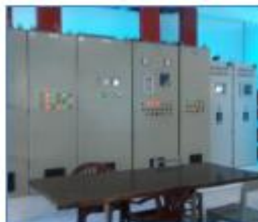
Sala de Tableros de Control y Mando
