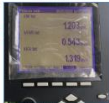
Panel de control del grupo N° 1
