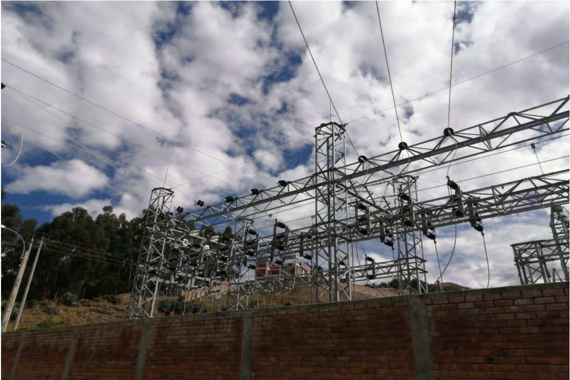
Vista del pórtico de salida 22,9kV SED Chuquibambilla
