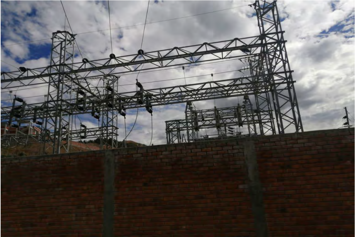
Vista seccionador de línea CQ03
