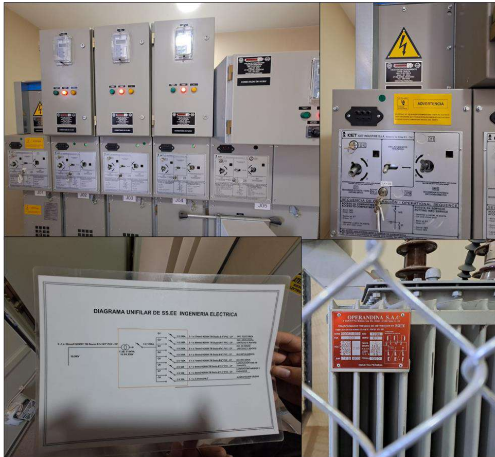
Fuente: Visita en Campo, Instalaciones de la S.E. de Ingeniería Eléctrica.
