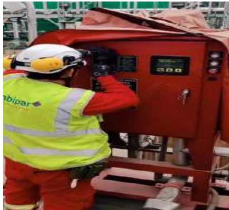
Fotografía 22. Inspección de bomba del sistema contra incendio
