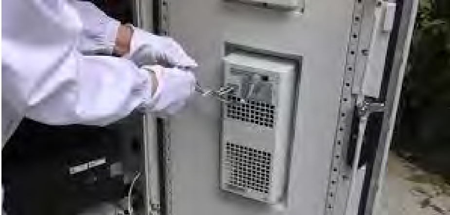
Figura 82 Verificación de sistema de ventilación en Shelter
