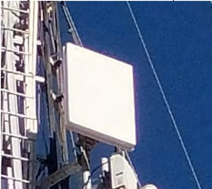
Figura 54 Forma y función de una AAU en site Wanchaq
