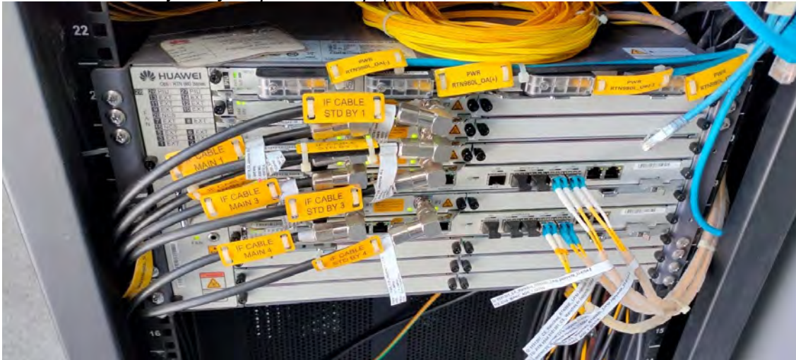
Figura 80 Verificación de tarjetas y limpieza de equipos
