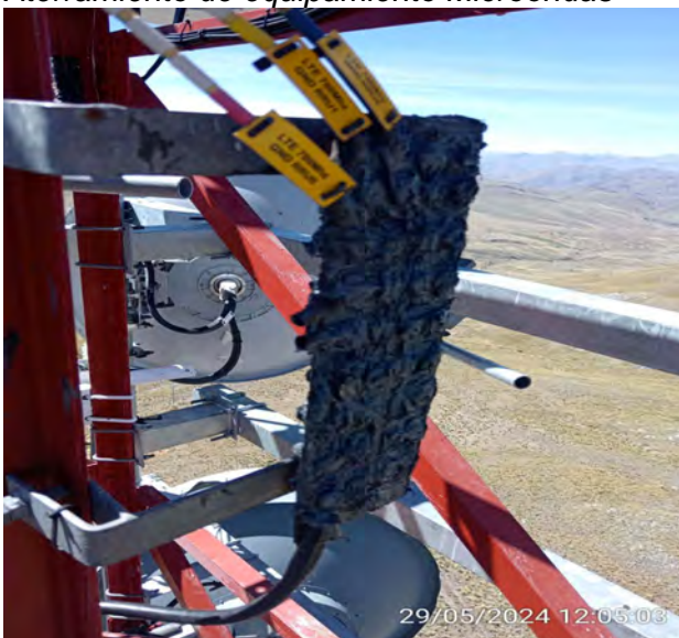
Figura 78 Aterramiento de equipamiento Microondas
