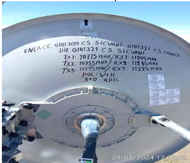
Figura 75 Codificación de antenas en preventivo
