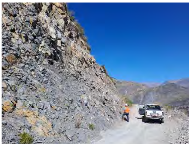
Foto 24: Vista del desmoronamiento de roca en matriz arcilla arenosa
