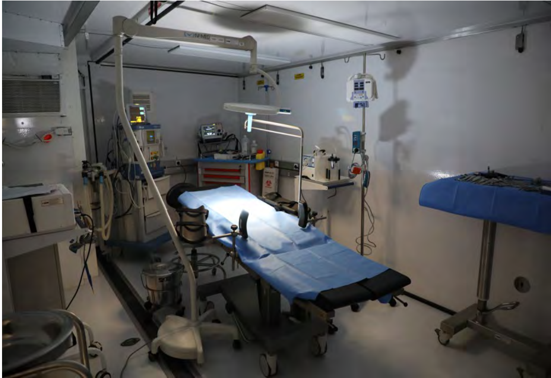
Figura 3: Equipamiento biomédico instalado en centro quirúrgico
