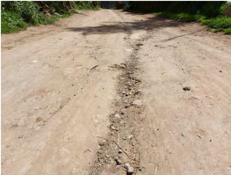
imagen 35: Surcos existentes en la Vía – situación actual.
