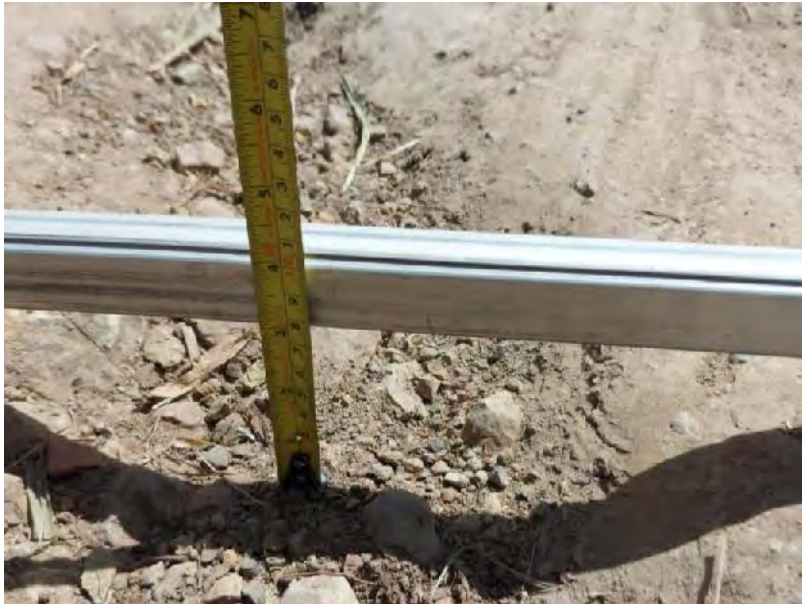
imagen 34: Surcos existentes en la Vía- tramo principal.
