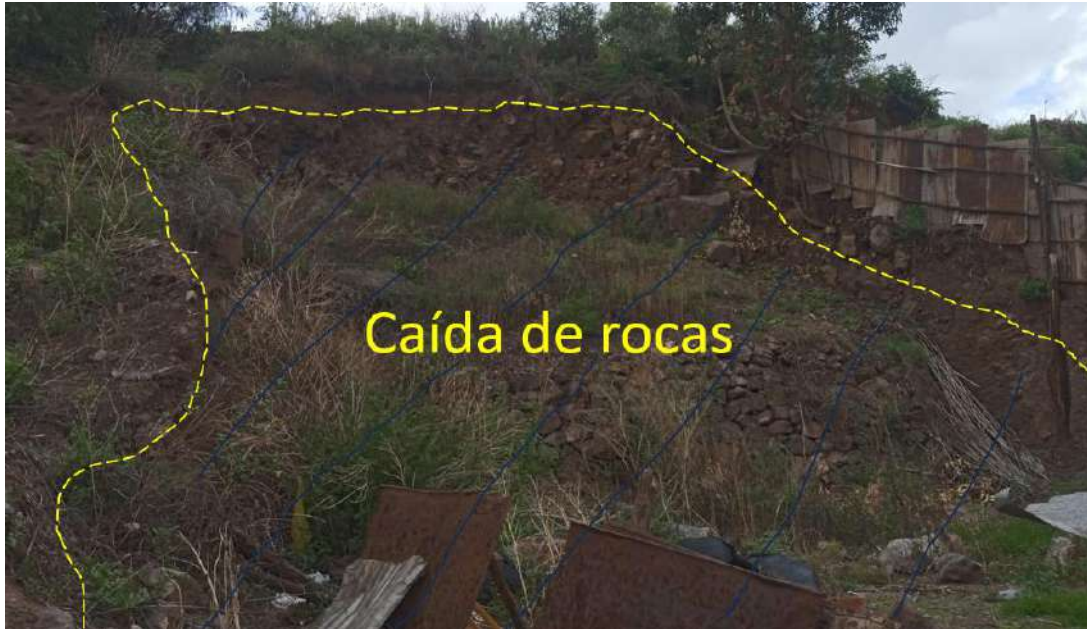
Figura. 63: Caída de rocas cercanas a viviendas unifamiliares
