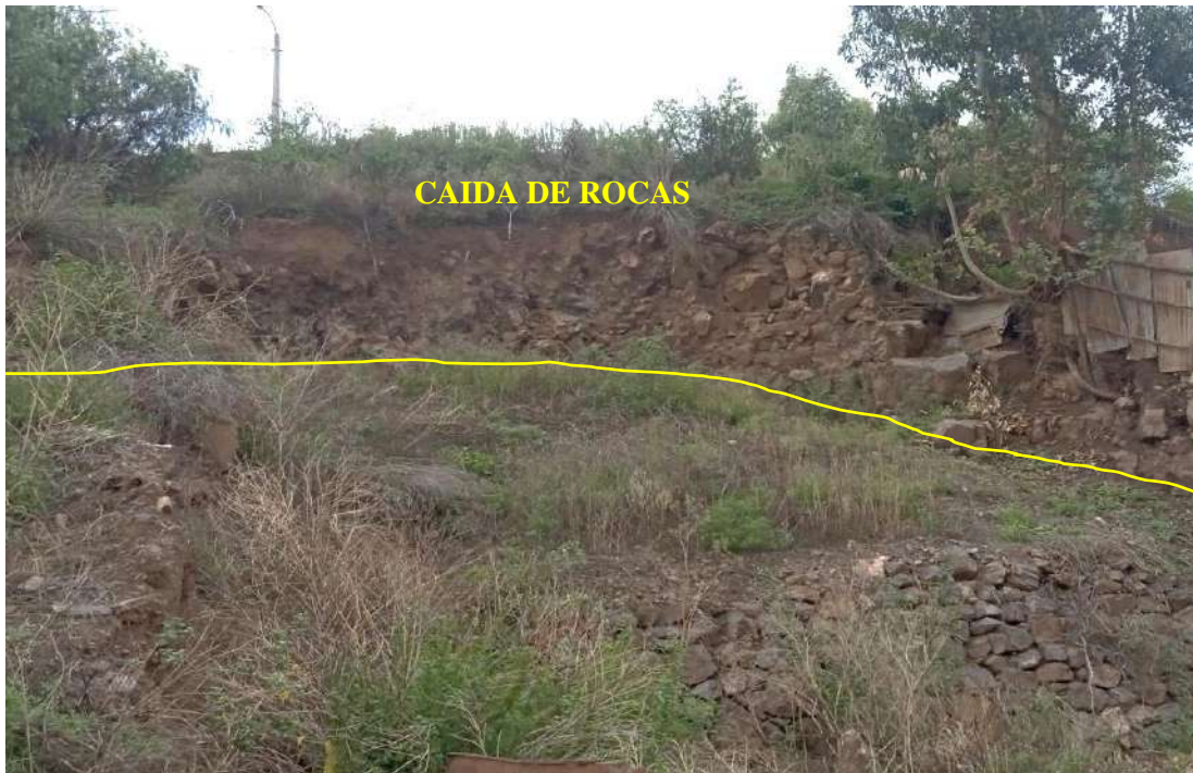
Figura. 61: Talud de pendiente abrupta con susceptibilidad a caída de rocas
