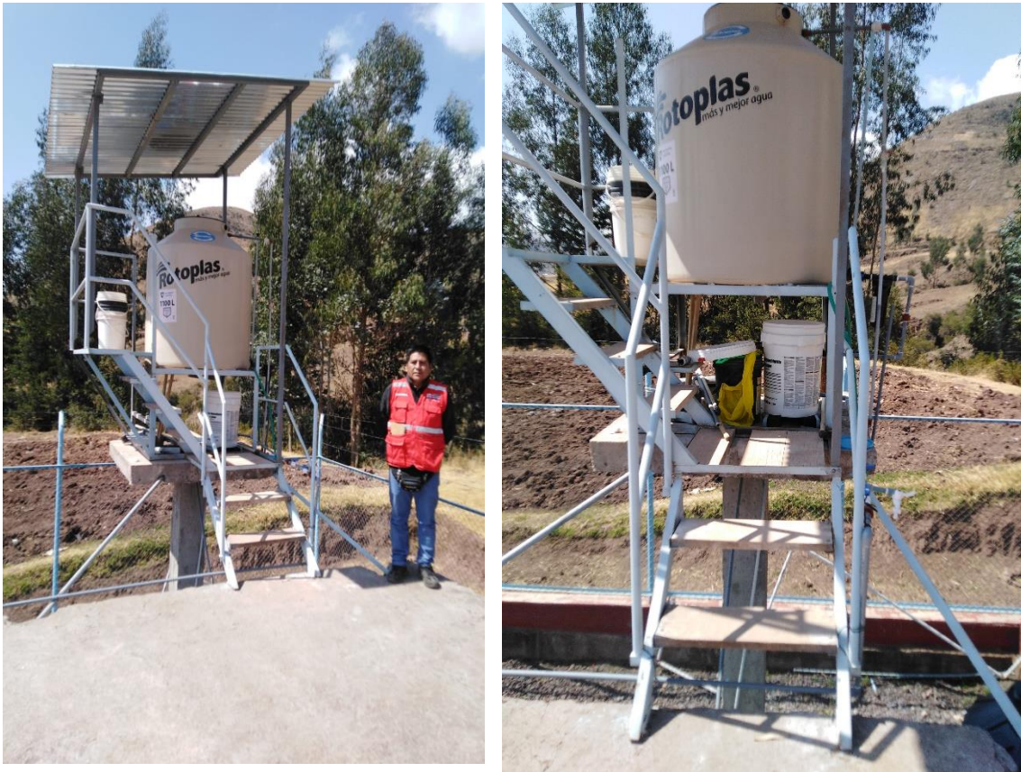
Foto 1 Sistema Doble tanque
