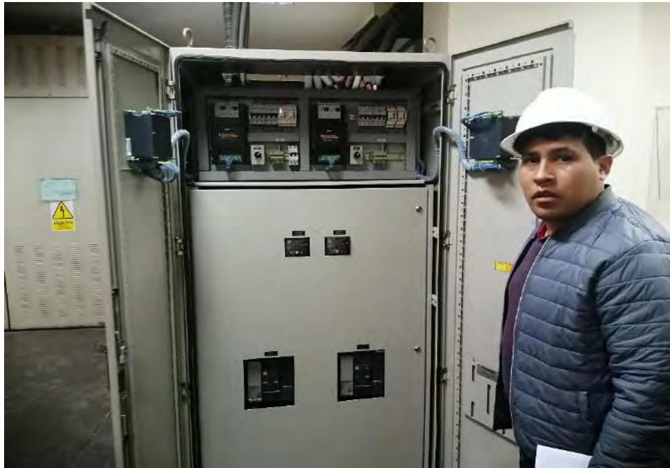
Anexo E: Tablero de control de la SED 0011013
