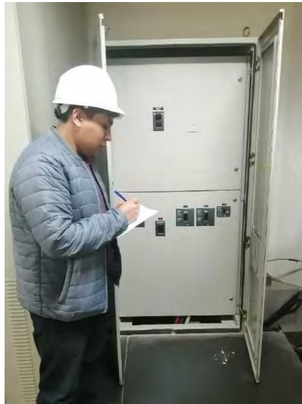
Anexo H: Tablero de los interruptores generales
