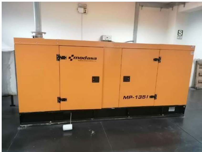
Anexo I: Grupo electrógeno de la Clínica Mac Salud Cusco
