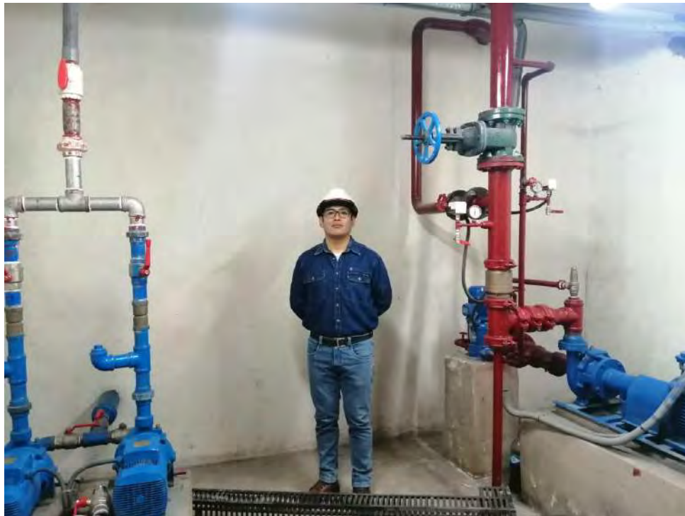
Anexo G: Cuarto de máquinas de las bombas de agua
