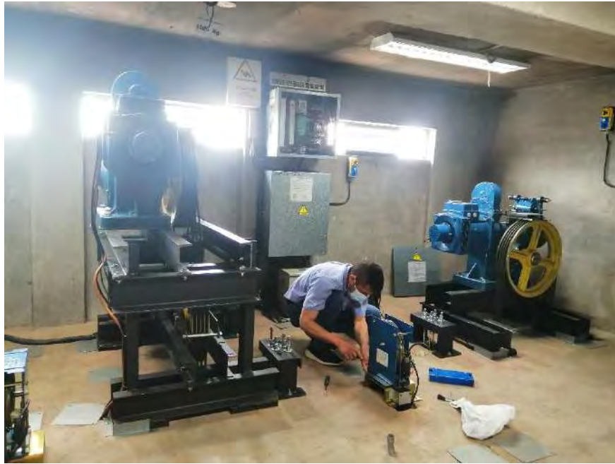
Anexo F: Cuarto de máquinas de los elevadores
