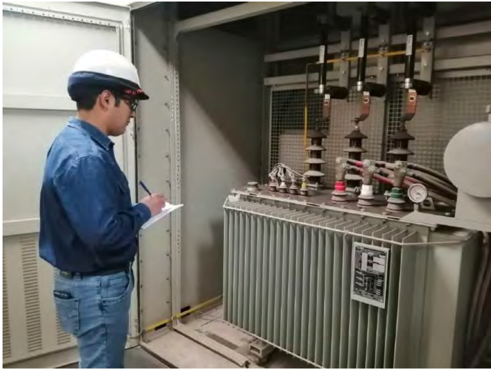
Anexo D: Transformador de la Clínica Mac Salud Cusco
