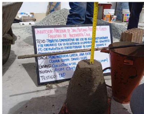
SLUMP DE AGUA SUBTERRANEA: 3"
