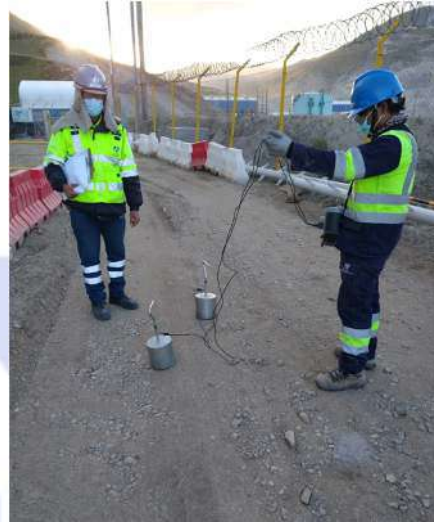
Medición de tensión de paso exteriores almacén
