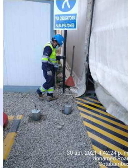
Medición de tensión de toque en almacén mina
