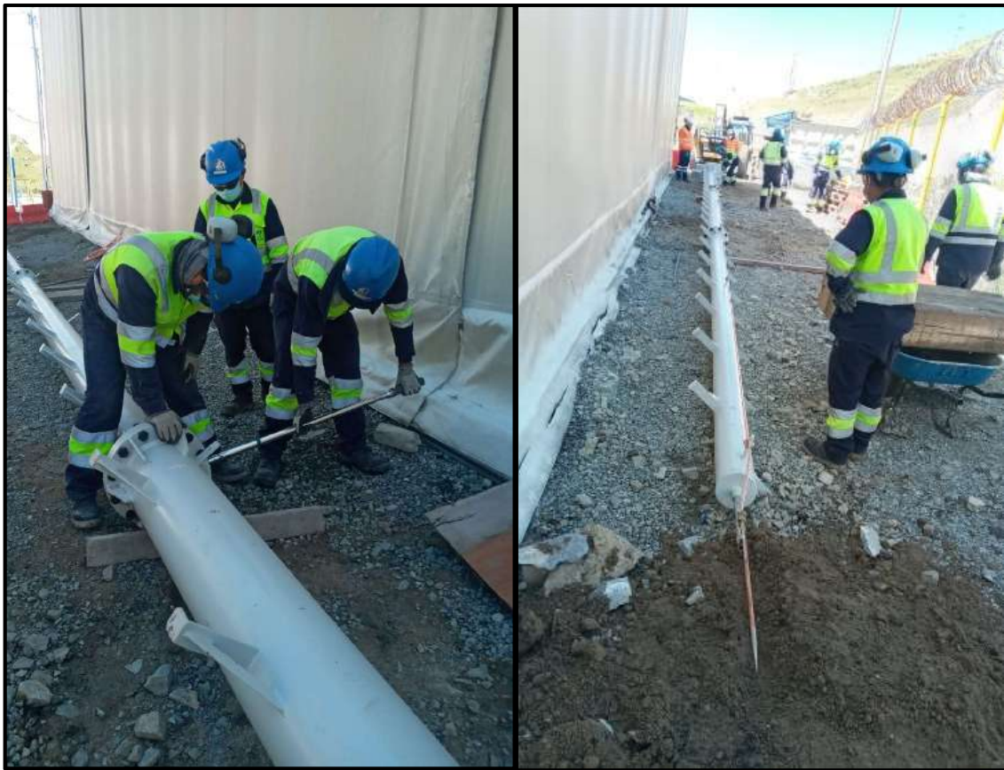
Fotografía 8. Ensamblaje de Terminal aérea y conductor de bajada
