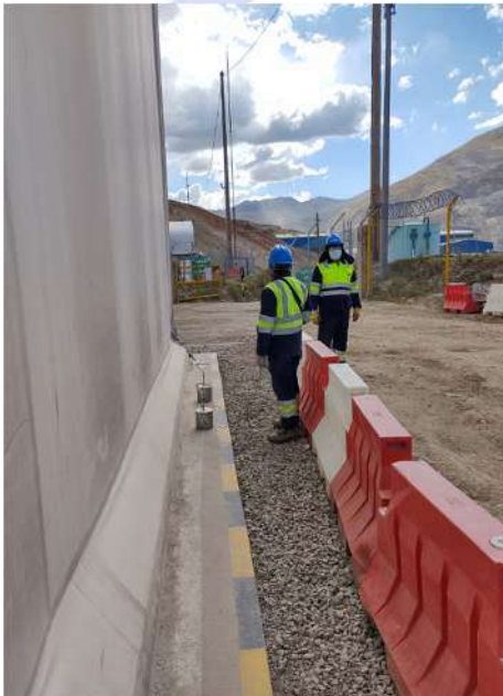
Medición de tensión de paso exteriores almacén
