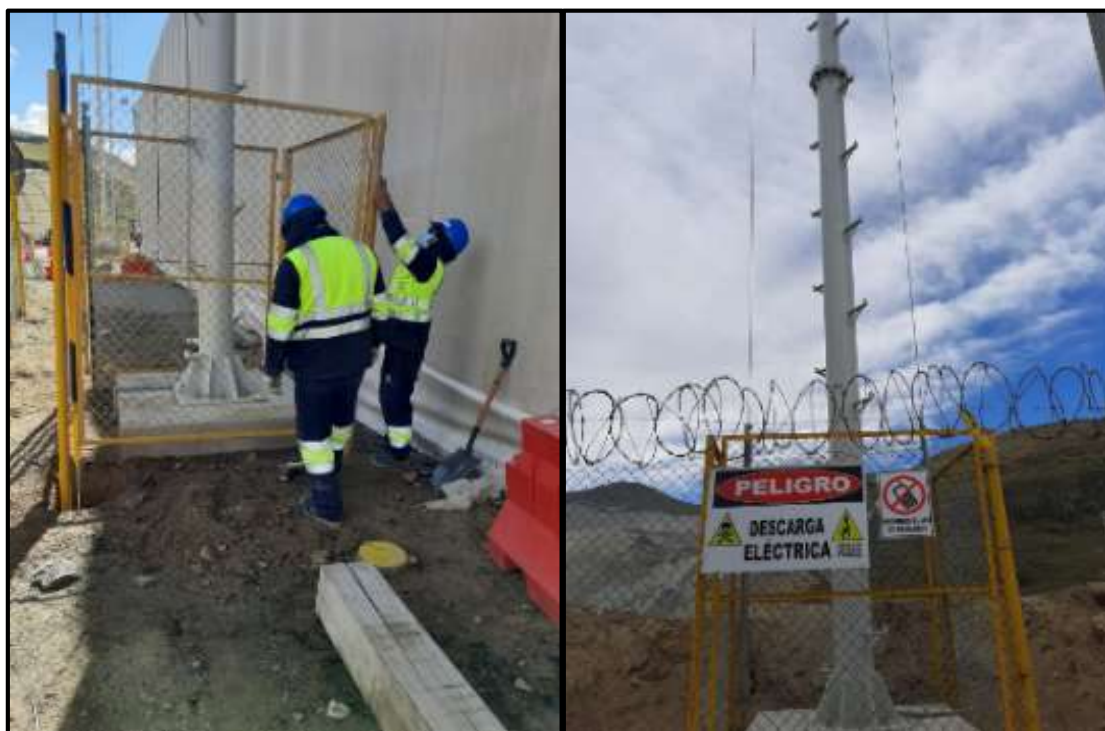
Fotografía 11. Implementación de restricción y señalética de riesgo eléctrico
