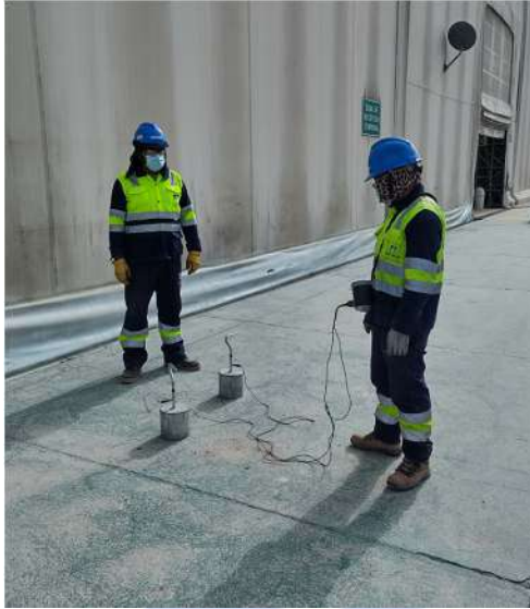
Medición de tensión de paso exteriores almacén
