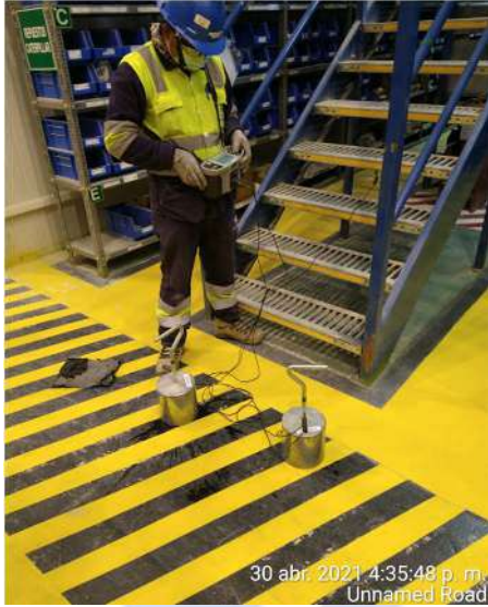
Medición de tensión de toque en almacén mina
