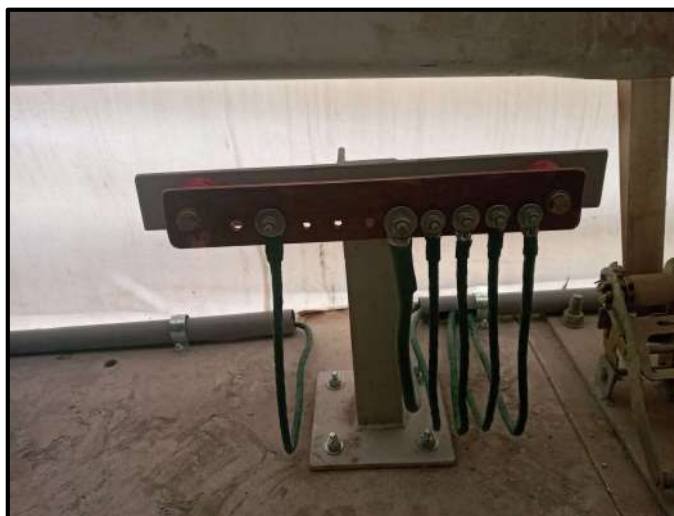
Fotografía 7. Señalización de puntos de equipotencialización de estructuras metálicas
