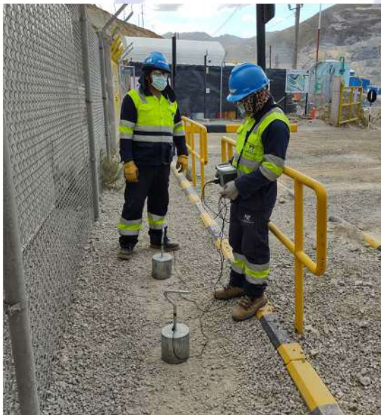
Medición de tensión de paso exteriores almacén
