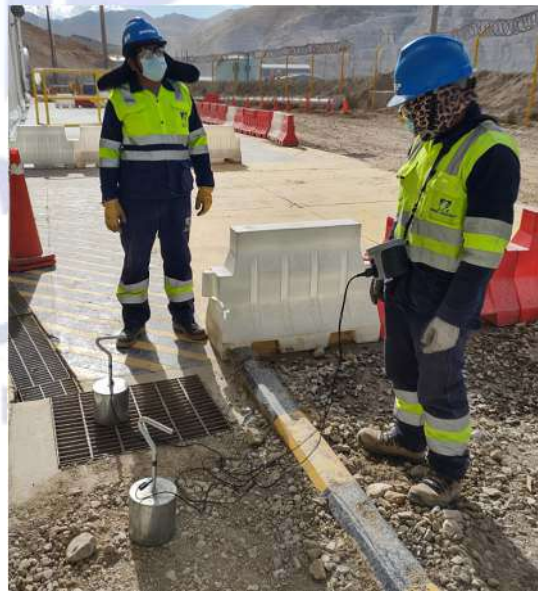
Medición de tensión de paso exteriores almacén
