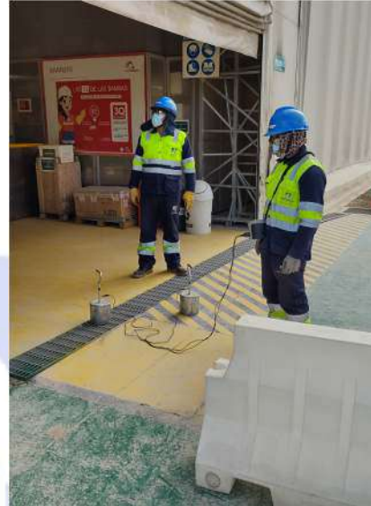
Medición de tensión de paso exteriores almacén
