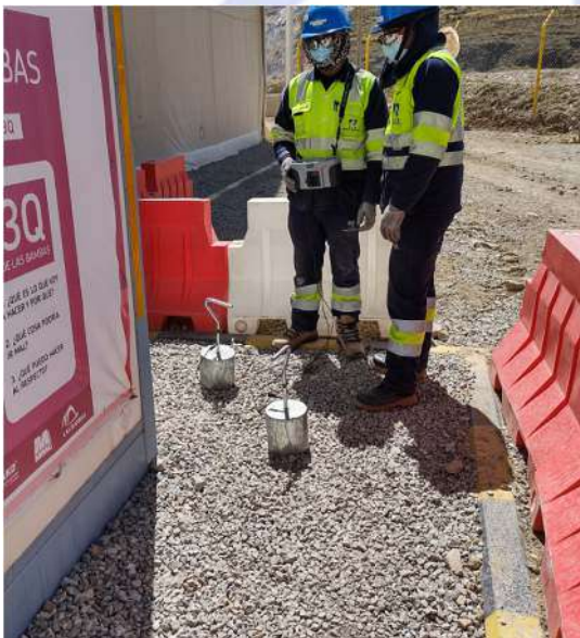
Medición de tensión de paso exteriores almacén
