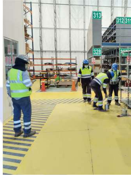
Medición de tensión de paso interiores de almacén
