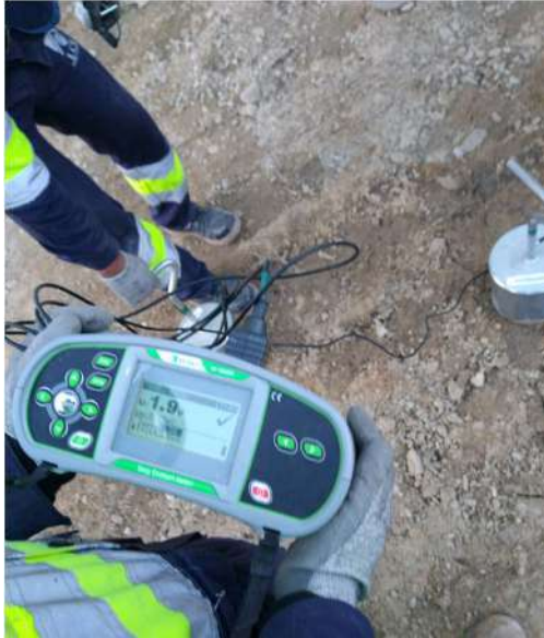
Medición de tensión de paso exteriores almacén
