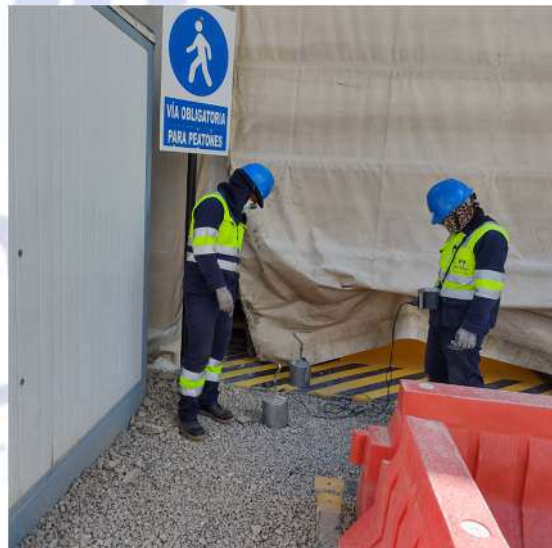
Medición de tensión de paso exteriores almacén
