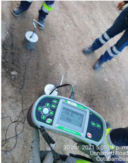
Medición de tensión de paso exteriores almacén
