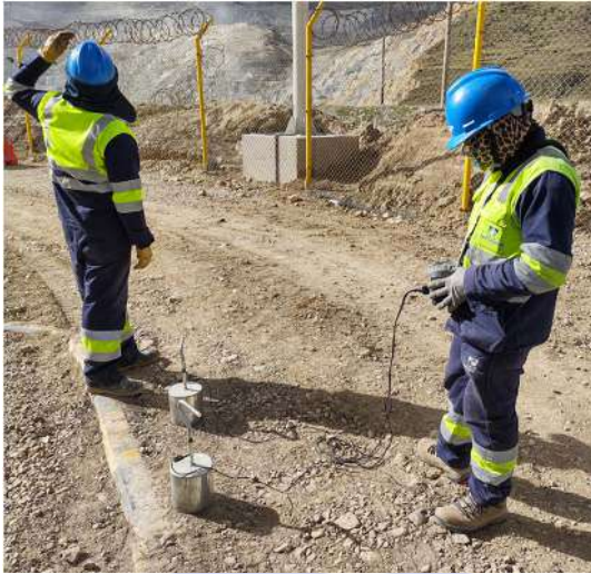
Medición de tensión de paso exteriores almacén
