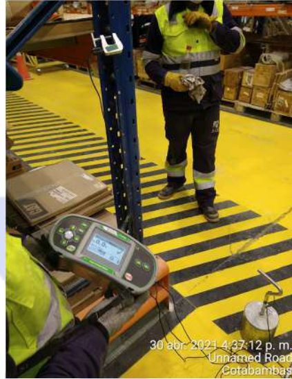
Medición de tensión de toque en almacén mina
