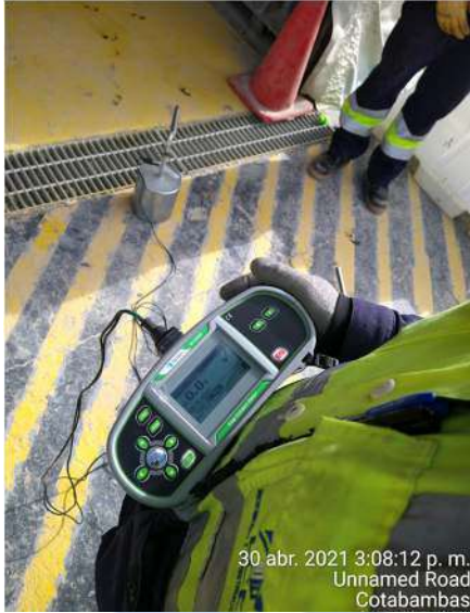
Medición de tensión de paso interiores de almacén
