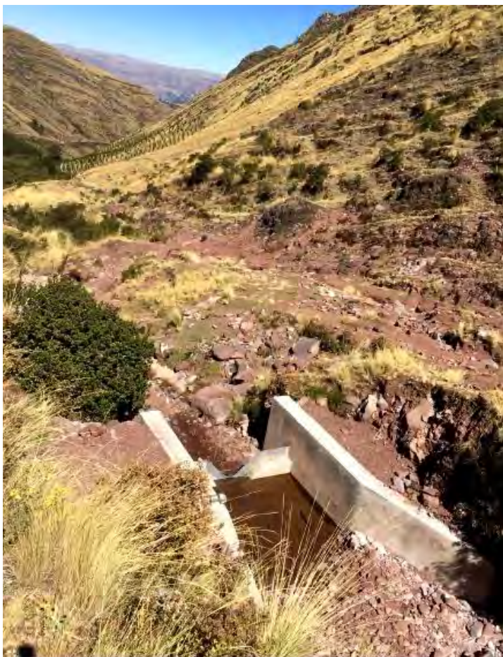
En la figura 6) Vertedero con problemas de sedimentación.
