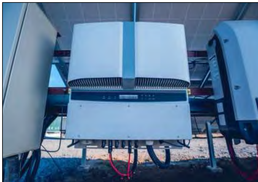
Figura 2 - 46: Inversor de sistema fotovoltaico
