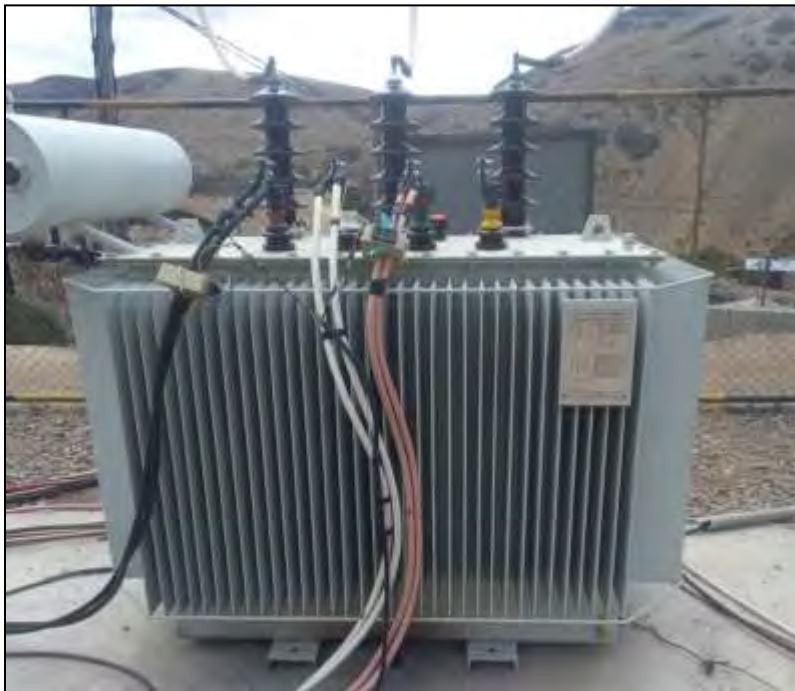
Figura 3 - 7: Transformador de potencia 800 kVA
