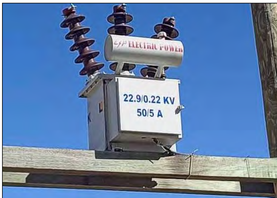
Figura 3 - 12: Transformador mixto de medida de la mina Antonio Raimondi.
