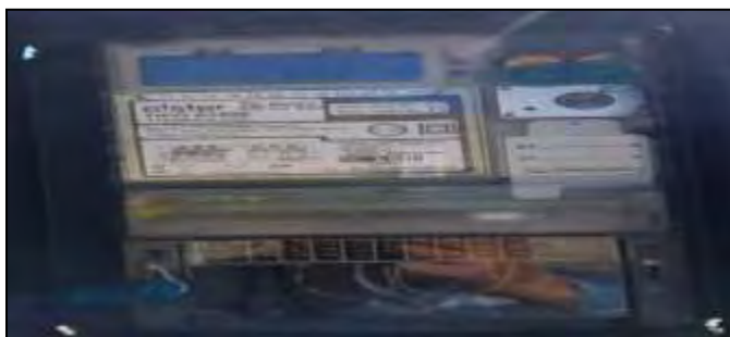
Figura 3 - 13: Medidor multifunción de la mina Antonio Raimondi
