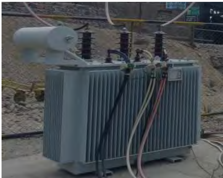
Figura 3 - 5: Transformador de potencia 500 kVA
