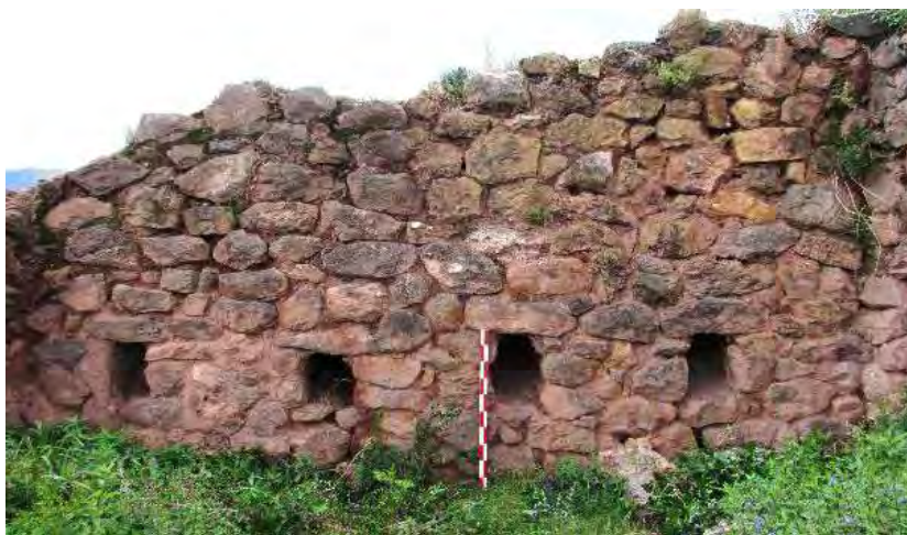
Nota. 04 ductos de ventilación en los muros laterales, distribuidas en forma lineal, depósito C17, Sub Sector "C"- Huaynaqolqa. Elaboración propia.
