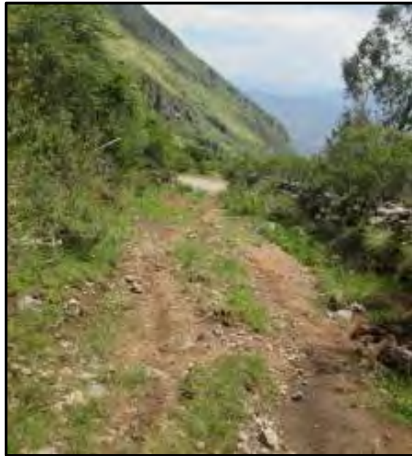
Camino Afectado por Fenómenos Antrópicos
