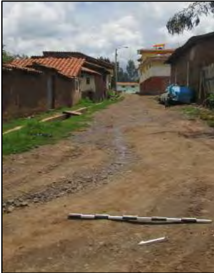
Camino Afectado por Fenómenos Antrópicos
