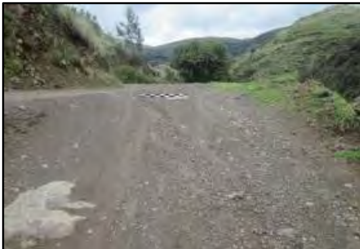
Camino Afectado por Fenómenos Antrópicos
