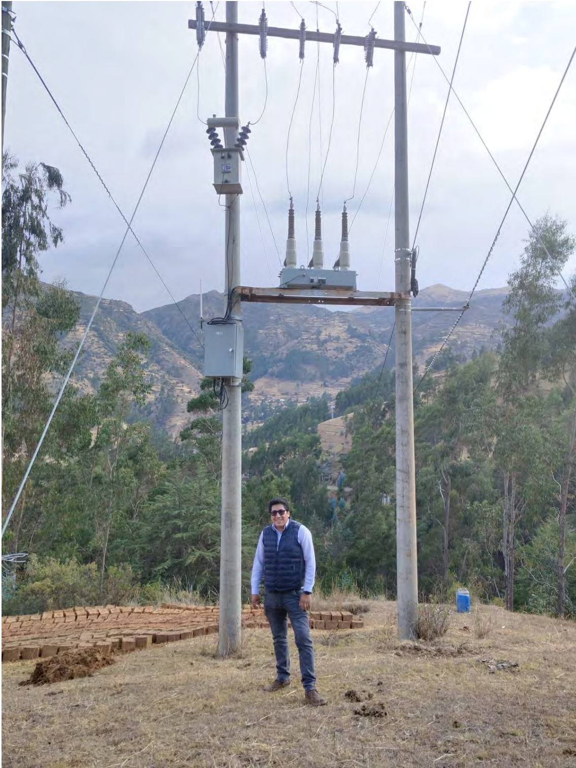
Fotografía N°10: detalle de estructura y RECLOSER R (Fuente: propia).
