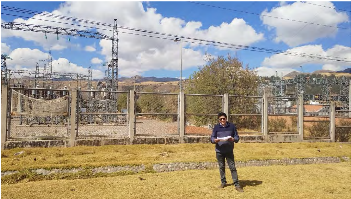
Fotografía N°2: Subestación de Cachimayo (Fuente: propia).
