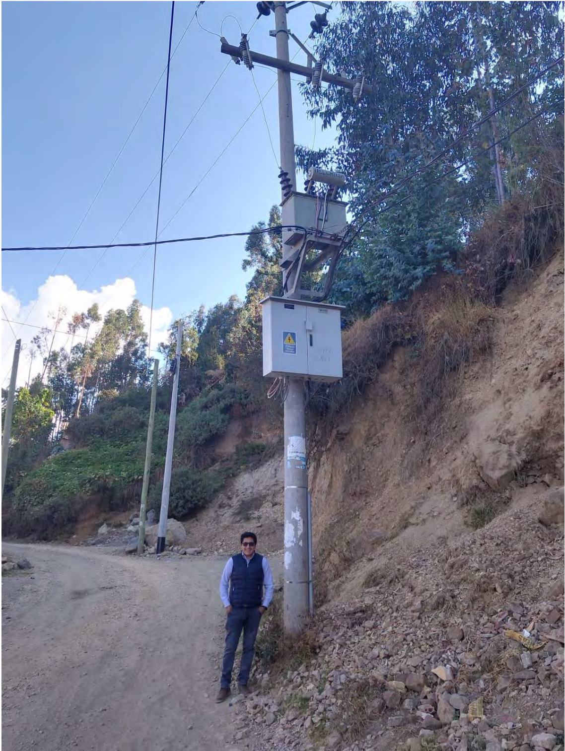
Fotografía N°8: SED 0070133 - Cotabambas (Fuente: propia).
