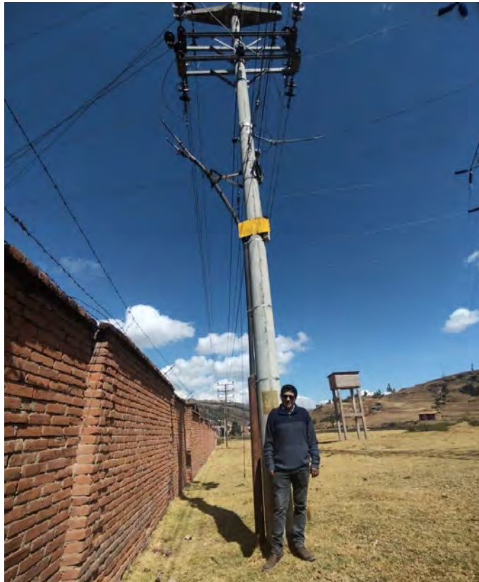
Fotografía N°6: estructura de línea de media tensión 22.9kV Tambobamba - Cotabambas (Fuente: propia).
