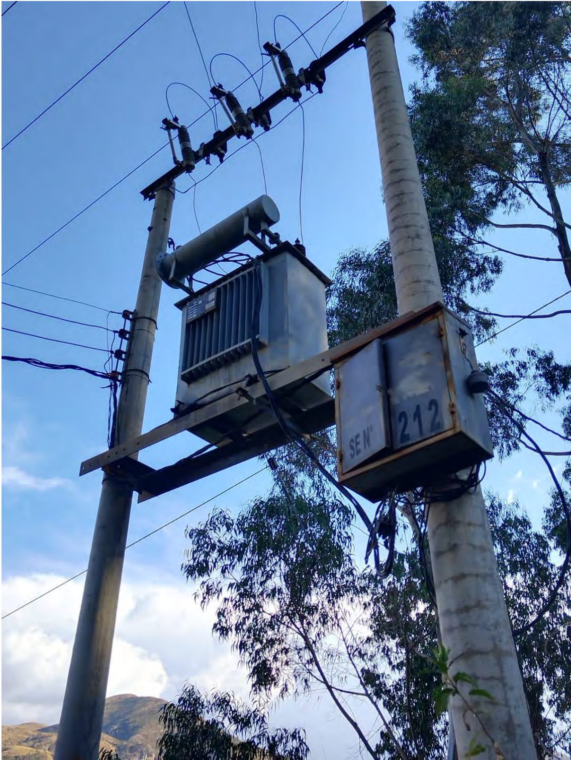
Fotografía N°7: detalle de estructura y ubicación de SED SANTA RITA:0070212 (Fuente: propia).
