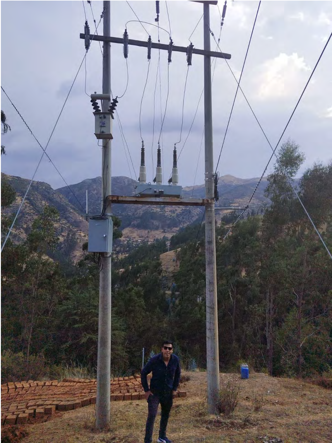
Fotografía N°11: detalle de estructura y RECLOSER R (Fuente: propia).
