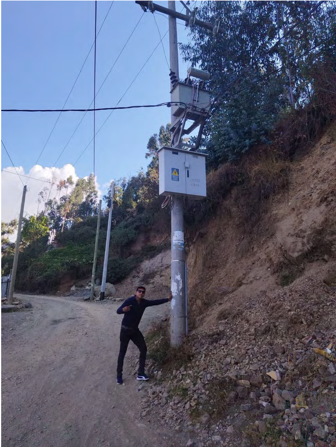
Fotografía N°9: SED 0070133 - Cotabambas (Fuente: propia).
