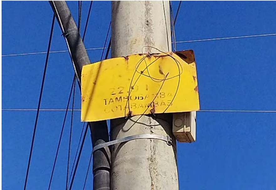
Fotografía N°5: línea de media tensión 22.9kV Tambobamba - Cotabambas (Fuente: propia).
