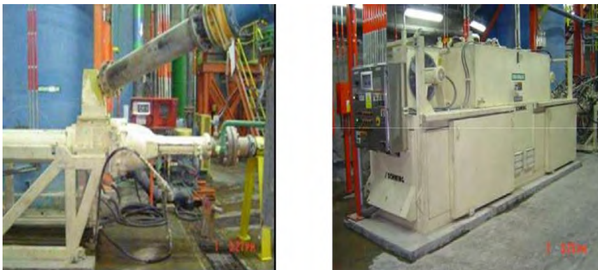
Fotografía N° 6 Bombas de desplazamiento de relleno
