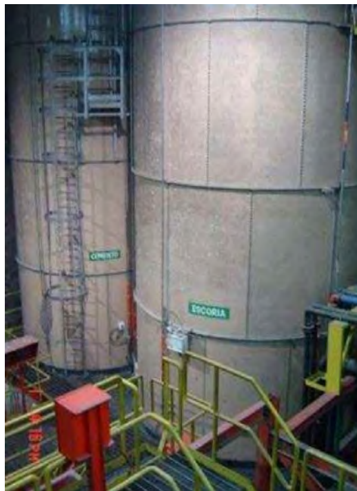
Fotografía N° 4 Tanque Almacenamiento Cemento y Escoria
