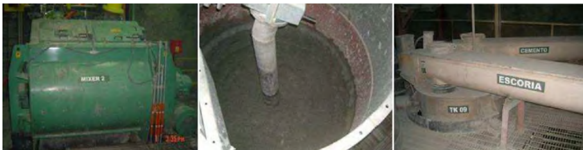
Fotografía N° 5 Sistema de Bombeo Relleno
