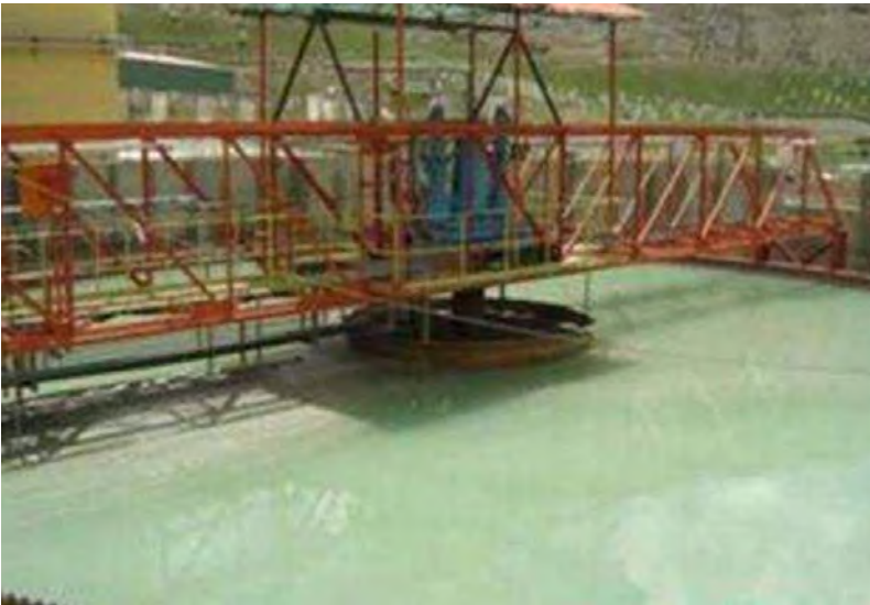
Fotografía N° 1 Espesado en Tanque de Floculación
