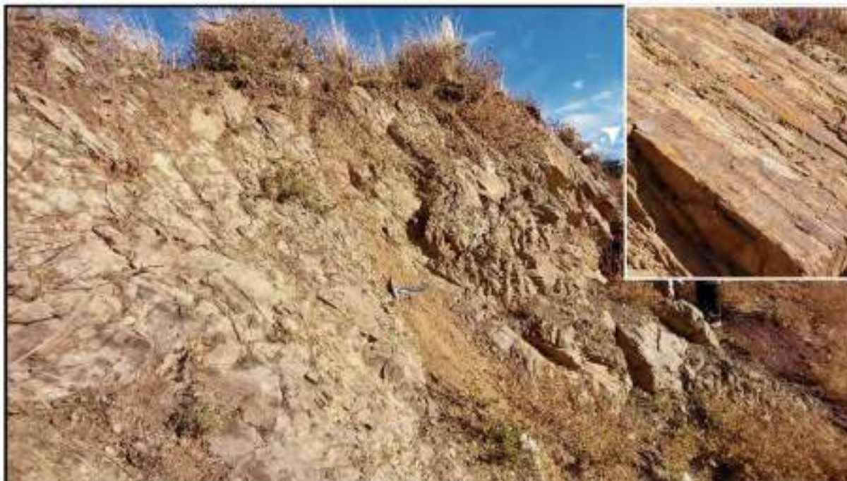
Figura 4. 33: Estación estructural E23. Fracturas con costra de calcita alterada. Fuente: Elaboración propia.
