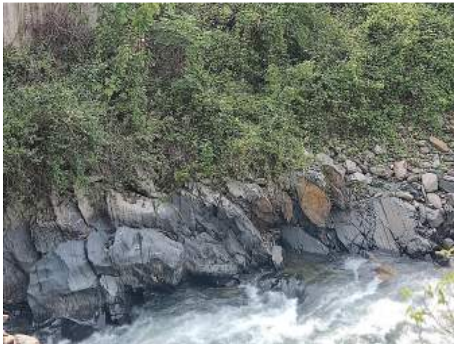
Erosión en la margen derecha
