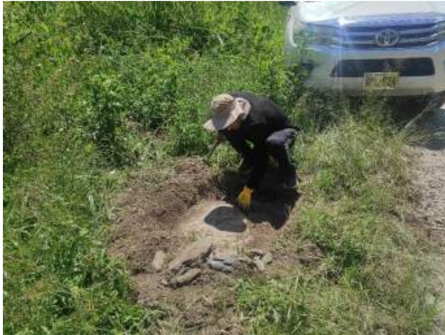
Excavación de calicata en la margen derecha y se encontró roca identificada como pizarra
