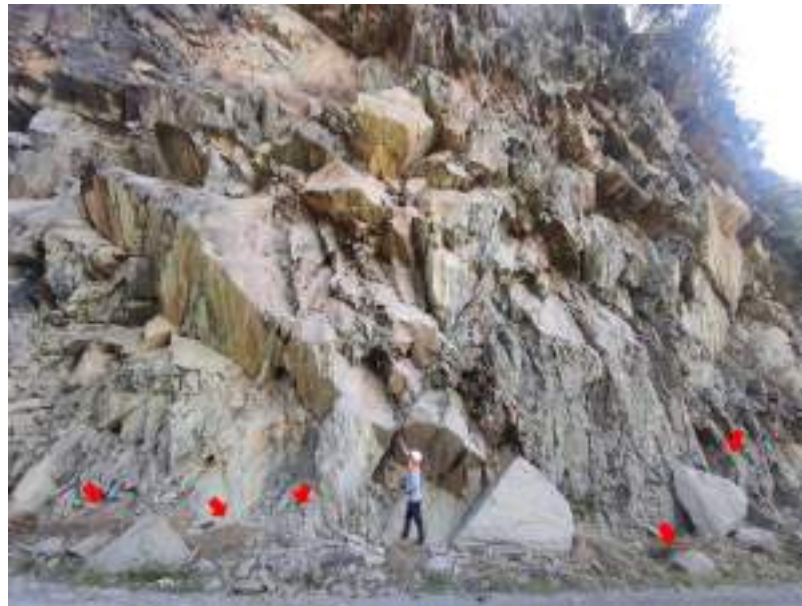
Fotografía N° 11: Caída de rocas por acción de la gravedad. Fuente: propio.
