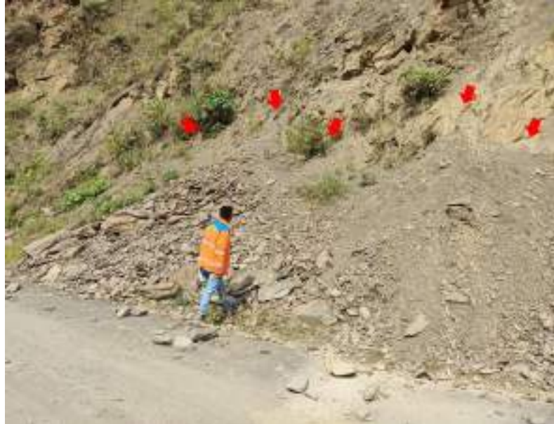
Fotografía N° 12: Visualización de pequeños derrumbes en la margen izquierda del río.
