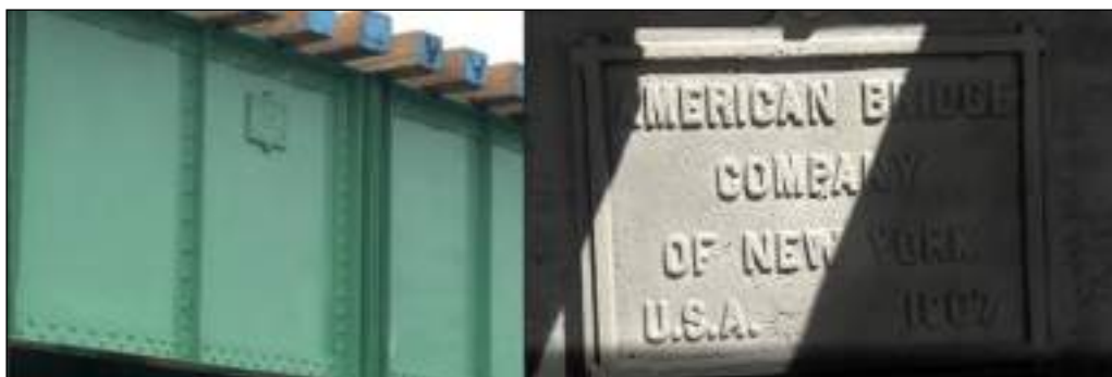
Figura 2. 17 Placa American Bridge Company, puente Sumbay en Ferrocarril del Sur. (Fuente: Fotografía Propia)
