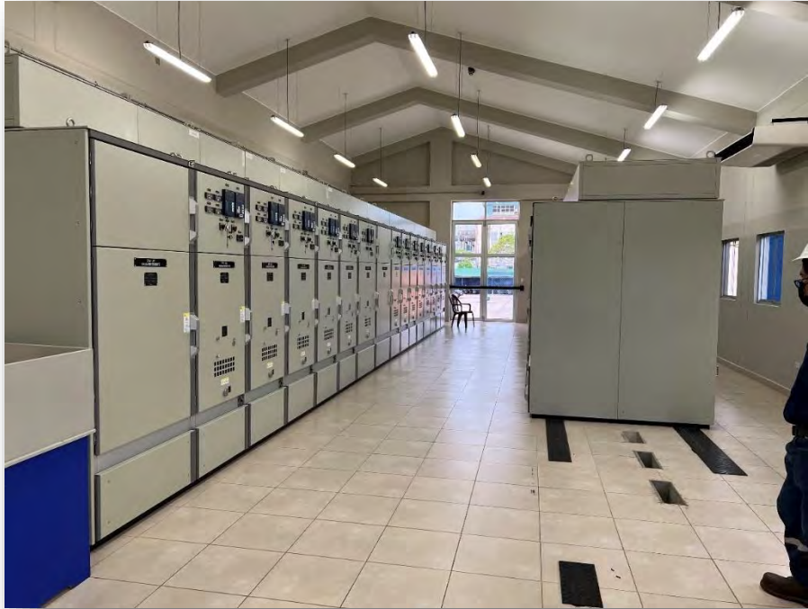
c) Vista de las celdas metal clad de 22.9 kV y 10 kV.
