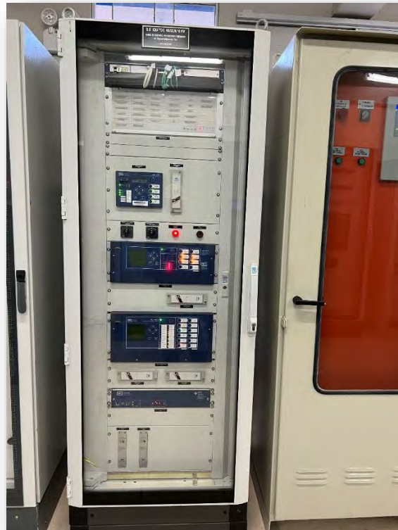
e) Tablero de Protección, Control y Medición del transformador de potencia.
