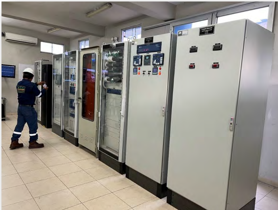
d) Vista los tableros de Protección, Control y Medición.
