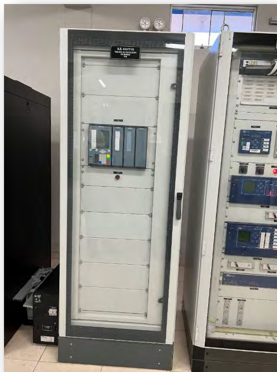
f) Tablero de Protección, control y medición de la LT 60 kV CTIN-Iquitos.
