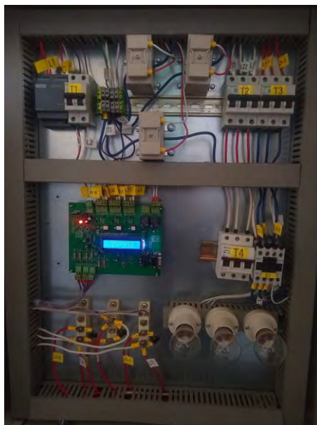
Figura 91. Tarjeta de control de carga en funcionamiento. Fuente: Elaboración propia.
