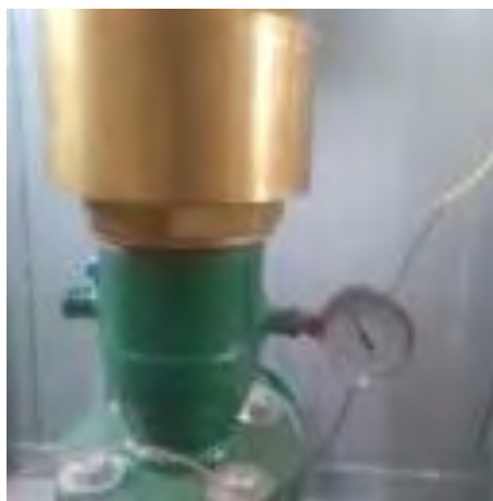
Figura 76. Manómetro en la descarga de la bomba madre. Fuente: Elaboración propia.
