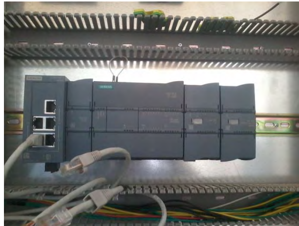
Figura 87. Instalación del PLC y sus módulos. Fuente: Elaboración propia.
