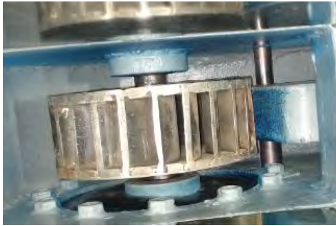
Figura 36. Vista interna de la Turbina Michell-Banki donde se puede observar el rodete y el difusor de la turbina. Fuente: Elaboración propia.
