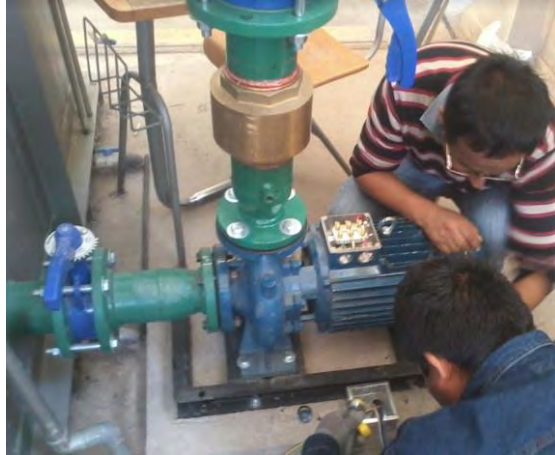
Figura 71. Instalación eléctrica del motor de la bomba principal. Fuente: Elaboración propia.
