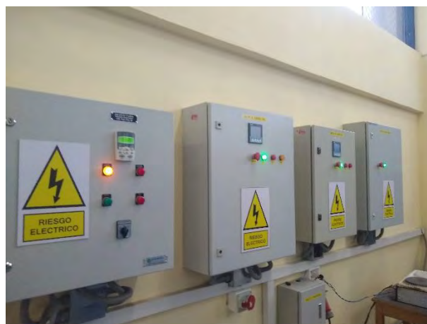
Figura 92. Vista de los tableros de control. Fuente: Elaboración propia.
