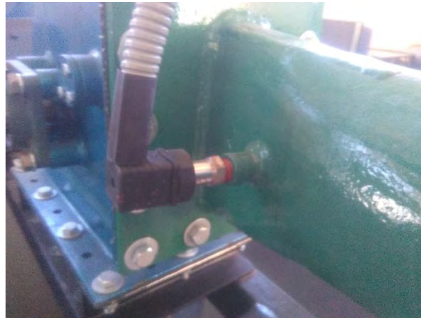
Figura 75. Instalación del Sensor de presión en la entrada de la bomba turbina. Fuente: Elaboración propia.
