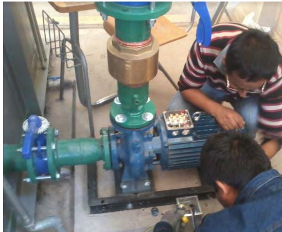
Figura 34. Línea de succión y descarga. Fuente: Elaboración propia.
