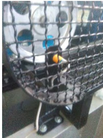
Figura 82. Instalación del sensor de presencia en la Turbina Michell Banki. Fuente: elaboración propia.
