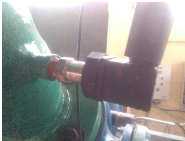
Figura 73. Instalación del Sensor de presión en la entrada de la bomba turbina. Fuente: Elaboración propia.
