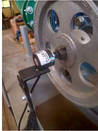
Figura 85. Encoder de velocidad en la turbina Michell-Banki. Fuente: Elaboración propia
