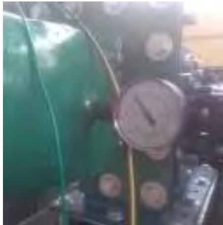
Figura 77. Manómetro en la entrada de la Turbina Michell-Banki. Fuente: Elaboración propia.
