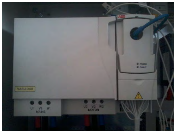
Figura 86. Variador de frecuencia que controla la bomba principal. Fuente: Elaboración propia.
