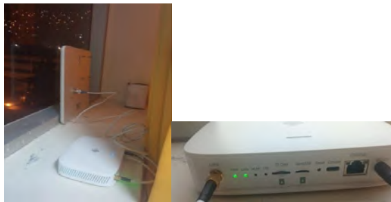
Figura 4.2: Antena Sirit y Gateway conectados (Elaboración propia)
