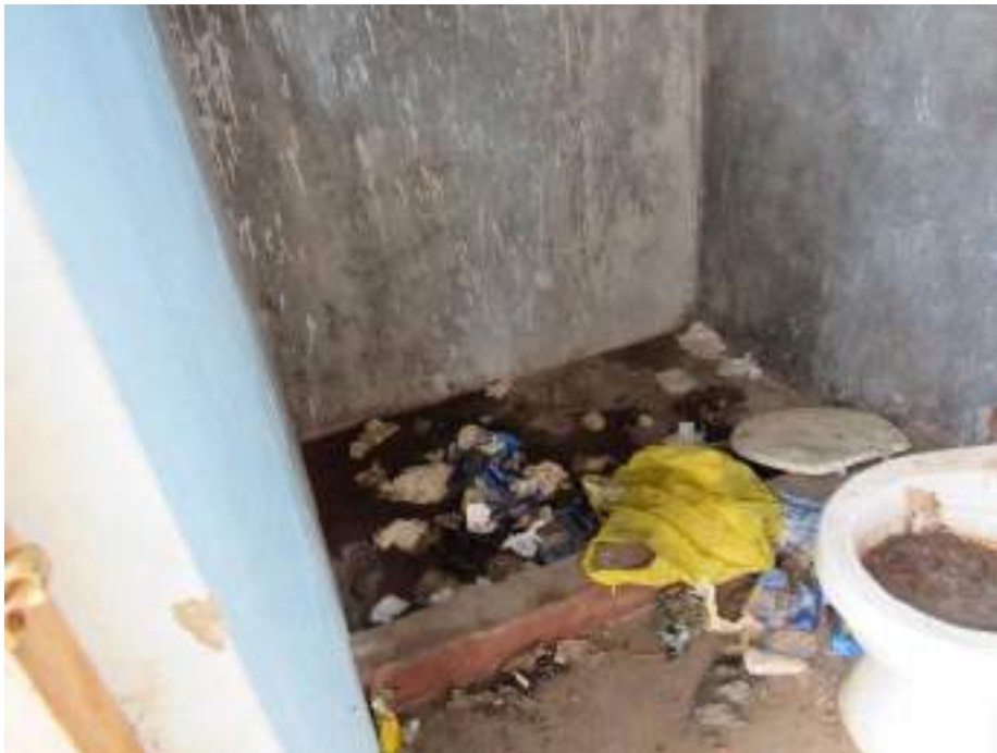
Construcción del sistema de saneamiento básico integral en la comunidad campesina de Pamputa del distrito de Coyllurqui, provincia de Cotabambas. En estado de abandono
