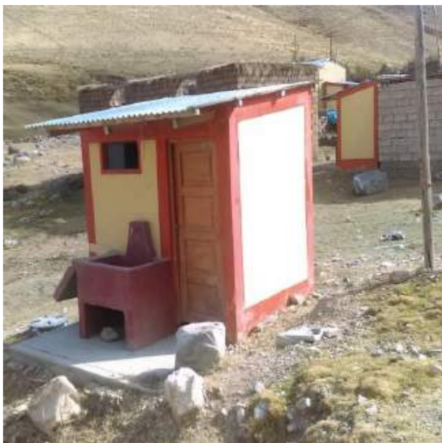
Proyecto: Mejora de sistema de saneamiento básico integral en la comunidad campesina de Escoorno, distrito de Progreso, provincia de Grau; UBS con batea rota.
