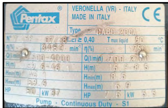
Figura 35: Datos de la placa de la bomba Pentax. Fuente: Elaboración Propia.
