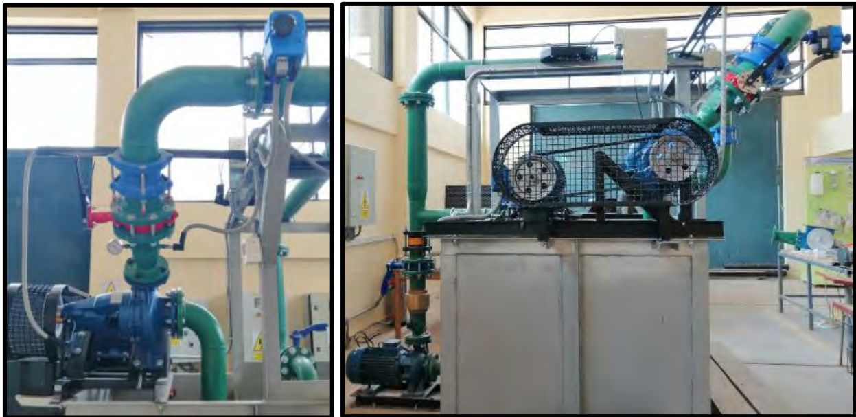
Figura 46: Componentes en línea de presión de la PAT. Fuente: Elaboración propia.
