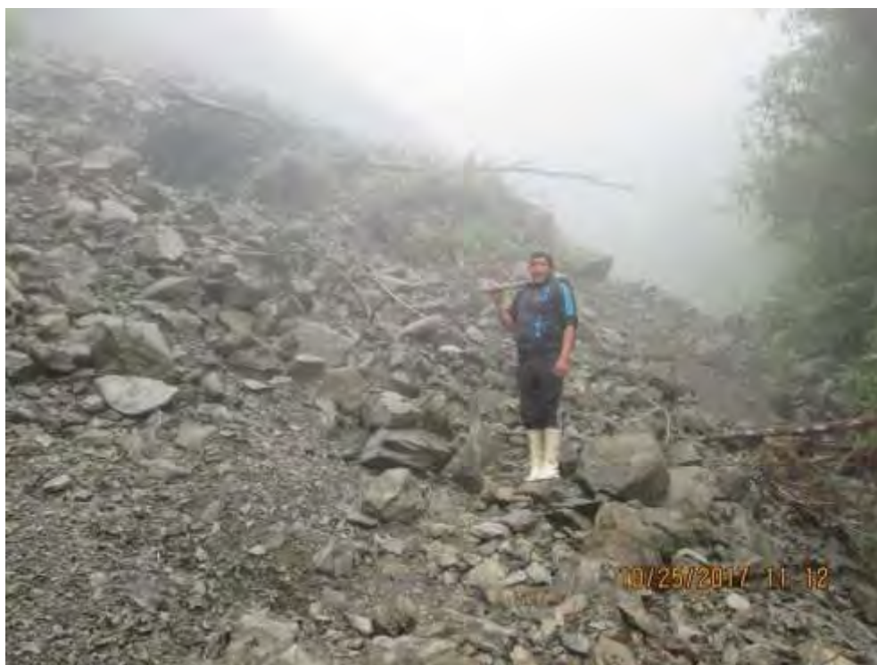
Figura 8. Aguas abajo de la veta 1, estribo derecho presenta depósito de deslizamiento.
