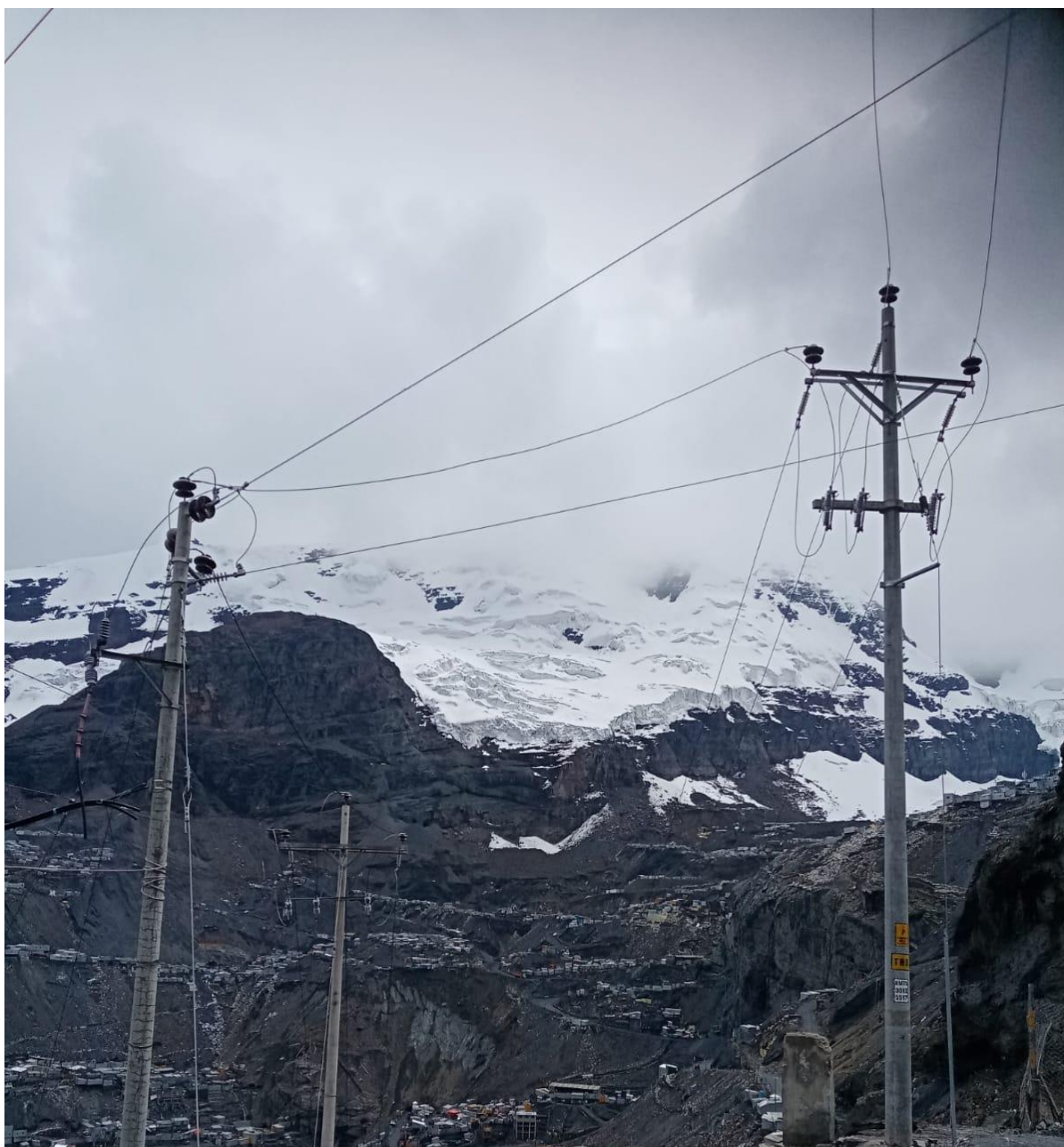
Figura 5. Estado situacional de las redes aéreas eléctricas
