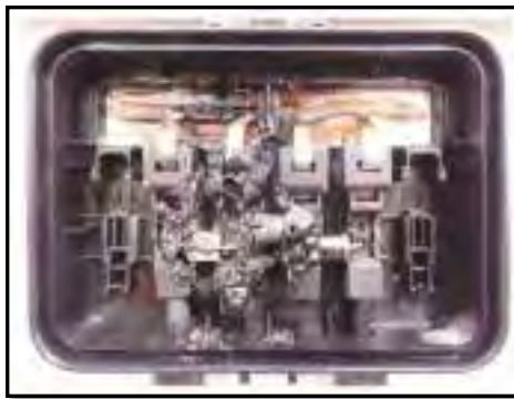
Figura 2-26. Caja de conexión con diodos bypass destruidos.
