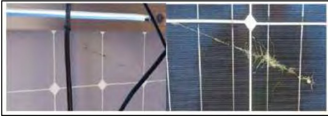
Figura 2-31. Módulos fotovoltaicos afectados por rayaduras.
