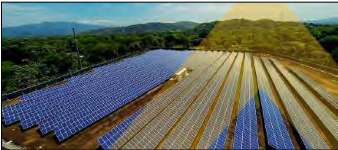
Figura 2-19. Planta solar fotovoltaica.
