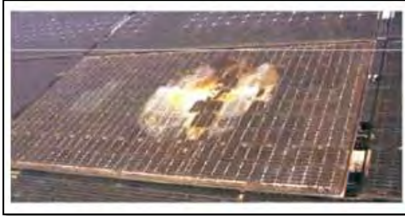
Figura 2-32. Panel fotovoltaico siniestrado.
