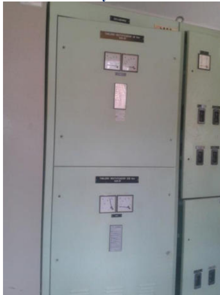
Figura 56 - Cargadores-rectificadores 220 VDC y 48 VDC.
