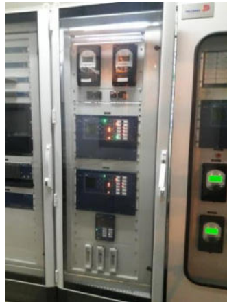
Figura 6 - Tablero de protección y CONTROL moderno
