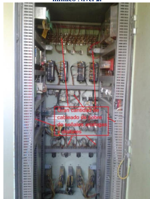
Figura 53 - Vista interior, Tablero Control mímico Nivel 2.
