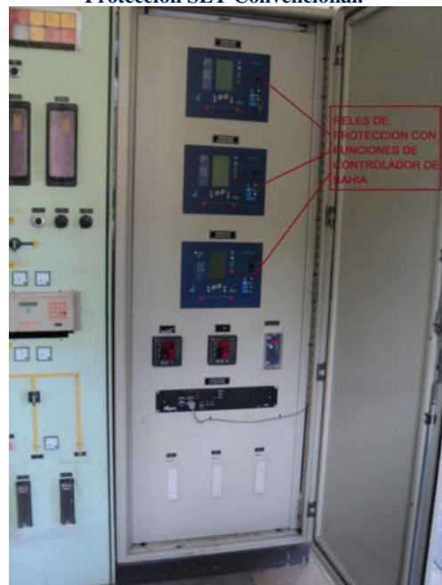
Figura 50 – Vista Frontal, Tablero de control y Protección SET Convencional.
