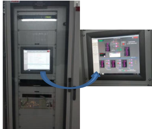
Figura 7 - HMI para control en una sala de control de una SET moderna.
