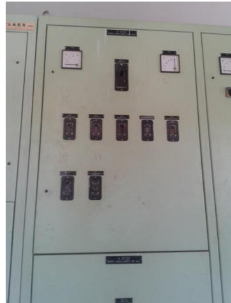
Figura 57 - Tablero de distribución de SSAA.
