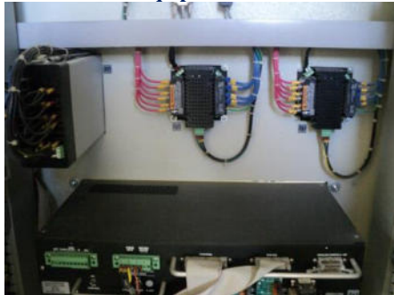
Ilustración 54 - Equipos Concentrador de SET
