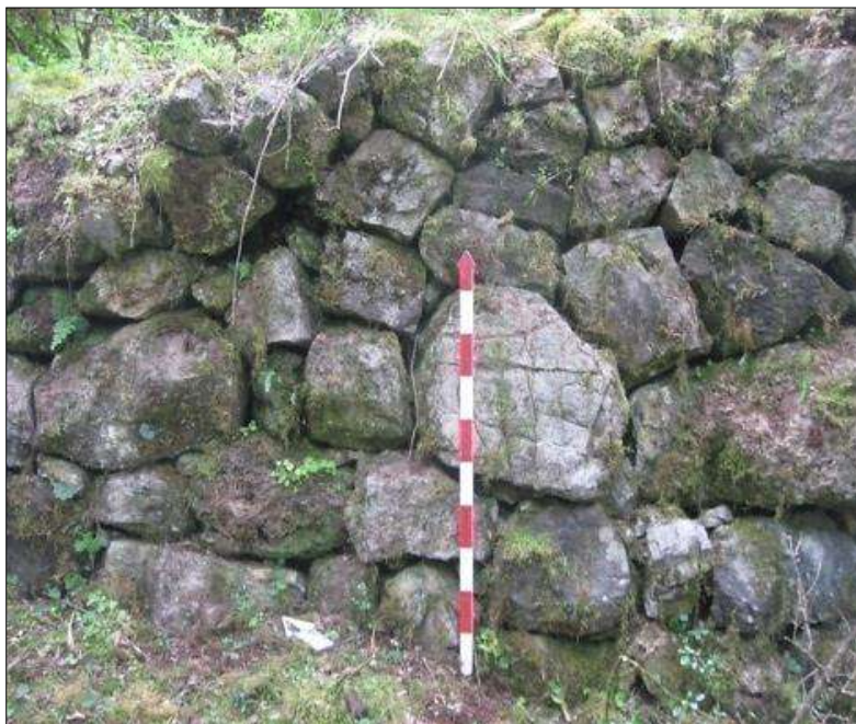
Fotografía 6. Vista del muro del primer anden del Sector B, perteneciente al S.A. de Paqaq'asa.
