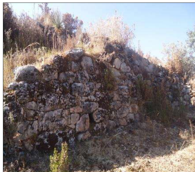
Fot. 27 Vista panorámica de los andenes de Cusimarca, caracterizada por una mampostería celular almohadillada. Tanto la parte baja como las cabeceras de muro están cubiertas por pastos y arbustos pequeños que deterioran rápidamente la estabilidad de estas estructuras.
