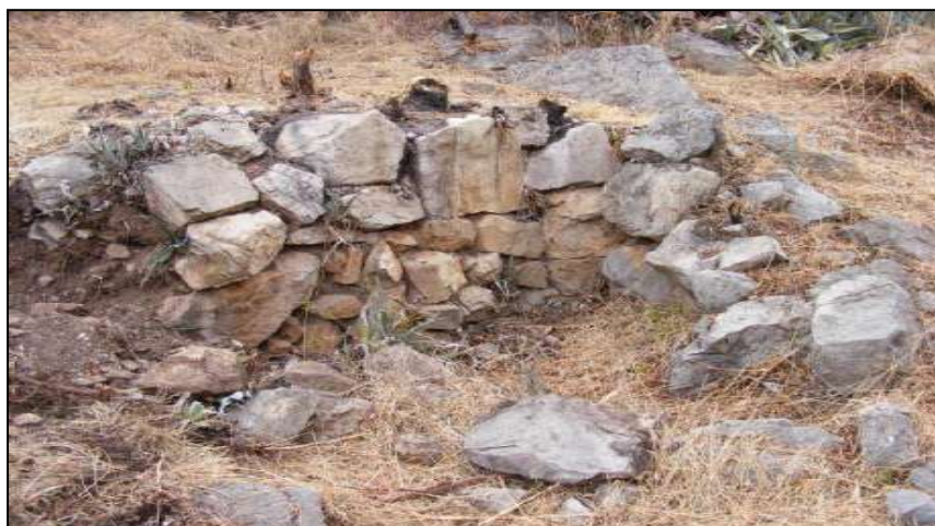
Fotografía 40. Vista de los muros de contención en el sitio de Qollpay. Obsérvese parte del muro colapsado hacia la pendiente donde se emplaza el sitio, objeto de estudio.
