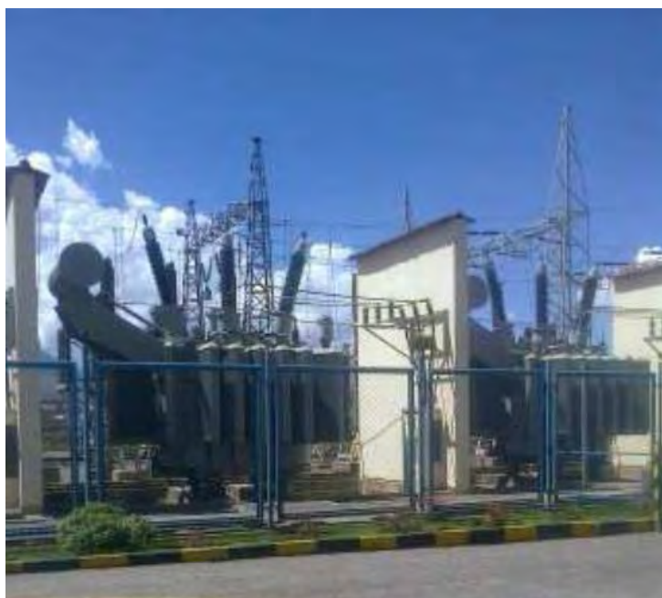
Figura 2-6 Subestación de Trasmformación Dolorespata-Cusco. Fuente: Elaboración Propia.
