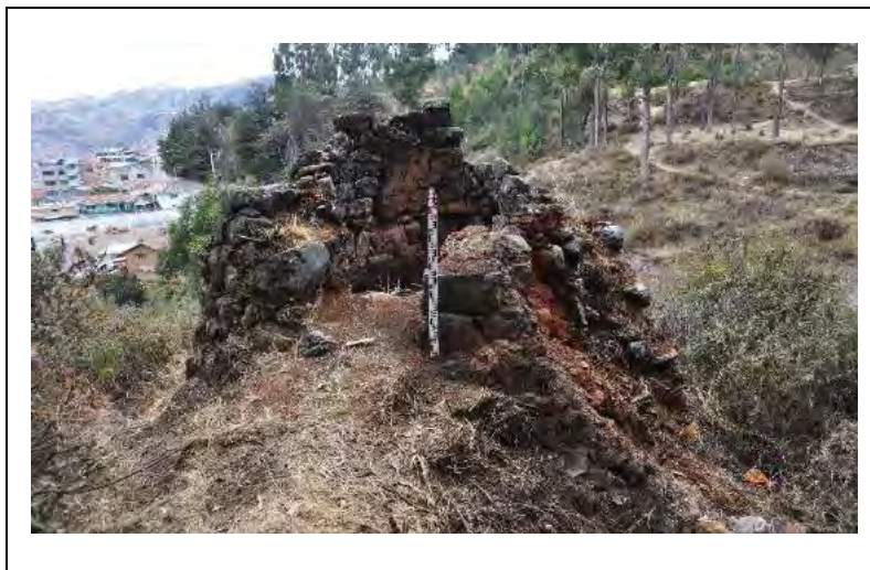
Figura 52. Boca de carga del horno N° 03
