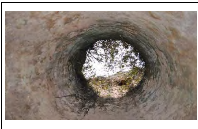
Figura 72. Cámara interna del horno, vista desde la parte inferior.
