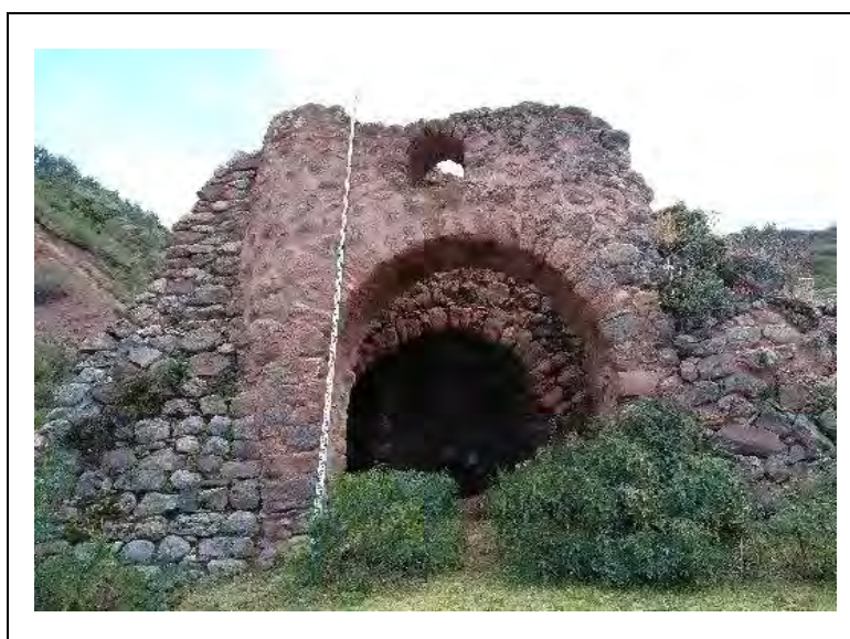
Figura 98. Horno N° 06, con contrafuertes o paravientos adosados a la estructura externa del horno.
