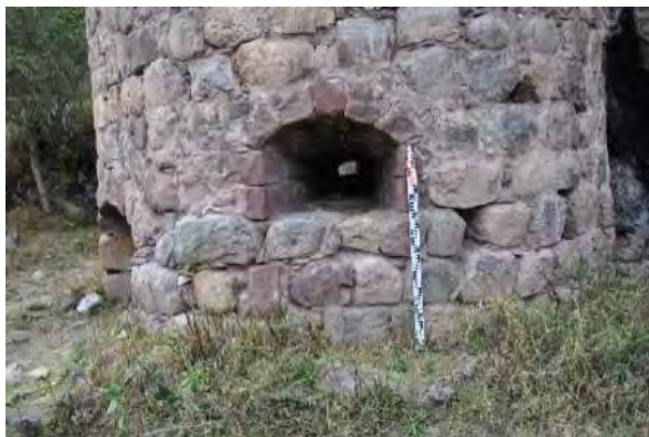
Figura 74. Ducto de ventilación horno N° 8 Fuente: Propia.
