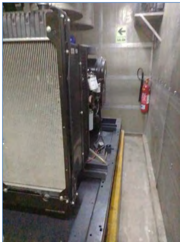
Figura 4.1. Grupo electrógeno. Fuente: Fotografía en campo.
