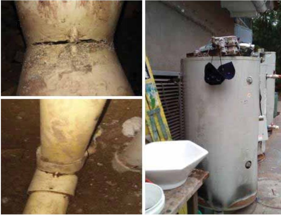
Figura 71. Mantenimiento de equipos
