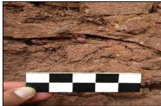
Foto 46 Enlucido en estructura 09. Fuente: (C.Pinares y M.Bravo)
