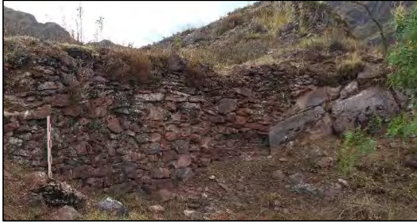
Foto 50 Muro de estructura. 01. construida adosada y adecuada al afloramiento rocoso. Fuente: (C. Pinares y M. Bravo)
