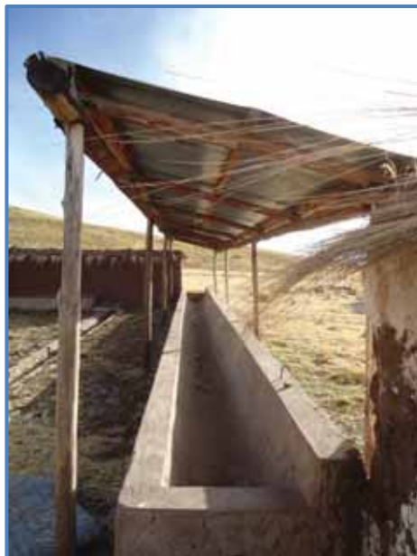
Figura 09. Vista lateral comedero.
