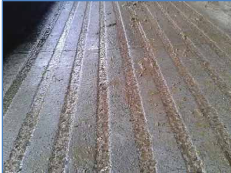
Figura 36. Ranurado longitudinal de piso para evitar accidentes.
