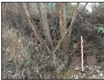
MURO DE CONTENCIÓN RELACIONADO A LOS MUROS LATERALES DE LOS RECINTOS CA5 - CA6
