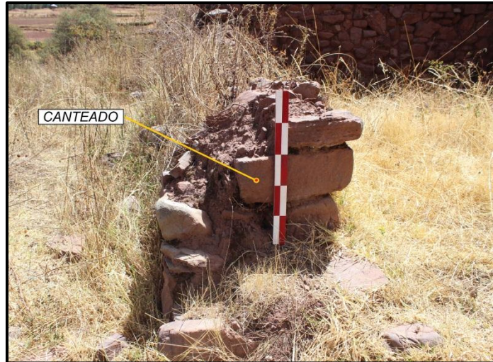
Foto 28. Trabajo de canteado en elementos líticos, conformantes del vano de acceso. (Fuente Propia)
