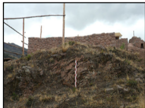
AFLORAMIENTO ROCOSO RELACIONADO AL RECINTO RA8, APROVECHADO A MANERA DE MURO DE CONTENCIÓN
