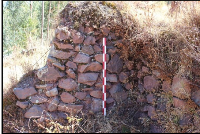
Foto 36. Se aprecia el Muro construido con lítico del tipo arenisca unida con mortero de barro. (Fuente Propia)
