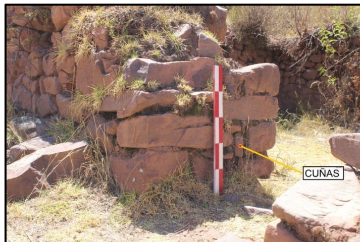
Foto 19. Presencia de cuñas en los muros del recinto. (Fuente Propia)
