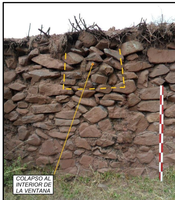
Foto 16. Presencia de ventana en pesimo estado de conservacion. (Fuente Propia)
