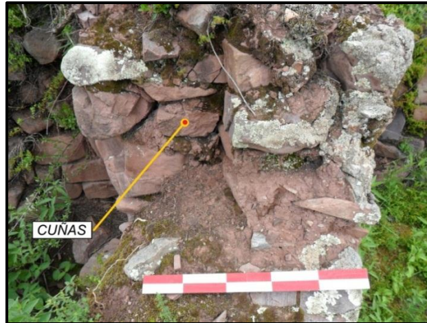
Foto 40. Presencia de cuñas al interior del muro del recinto. (Fuente Propia)
