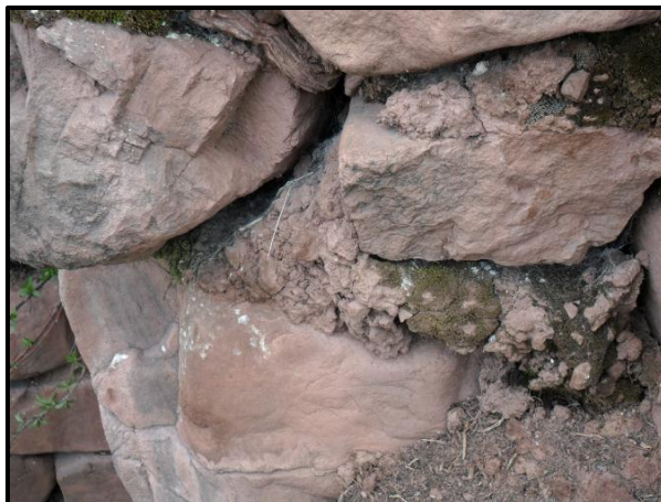
Foto 42. Mortero de barro con fines de fijación de líticos y estabilidad de los muros. (Fuente Propia)
