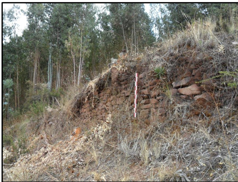
Foto 87. Muro de contención construida para estabilizar el terreno, el cual se halla en relación a los recintos RB16-RB20. (Fuente Propia)
