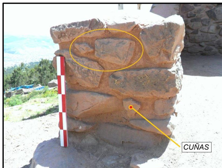
Foto 75. Presencia de cuñas en el muro del recinto. (Fuente Propia)
