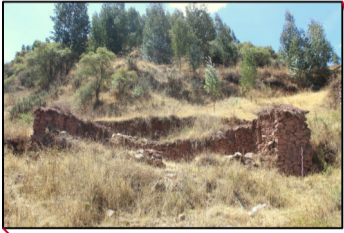
EL RECINTO CA4 ES UNO DE LOS POCOS QUE AÚN HAN CONSERVADO HORNACINAS EN SUS MUROS LATERALES
