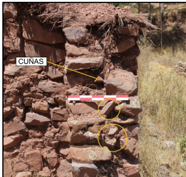
Foto 29. Presencia de cuñas unidas con mortero de barro al interior de los muros. (Fuente Propia)
