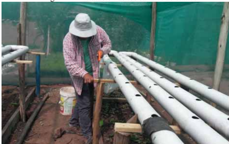
Fotografía 4: Instalación de los canales de cultivo
