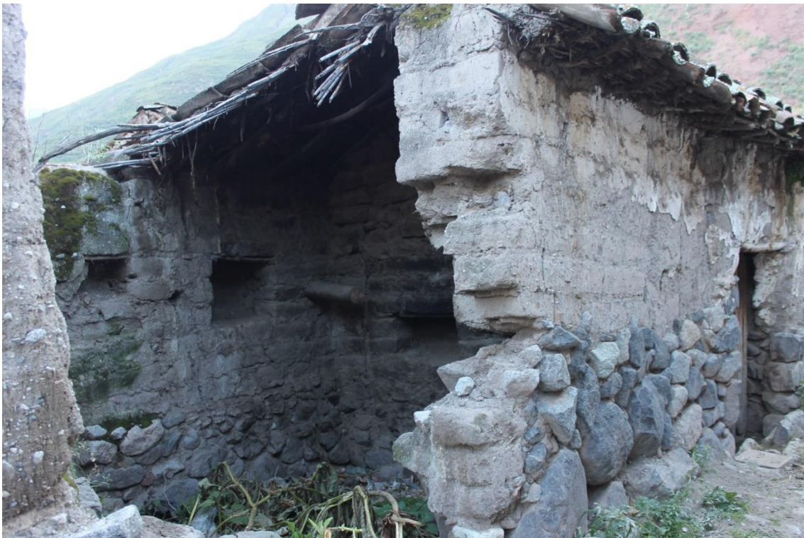
Fotografía 24: Casa abandonada, Fuente: Elaboración propia.
