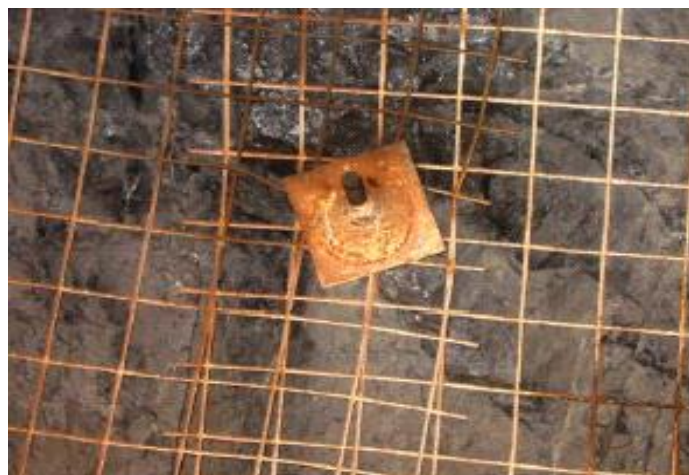
Figura 4.25 – Malla Electrosoldada TJ-927 Mina Carmencita.
