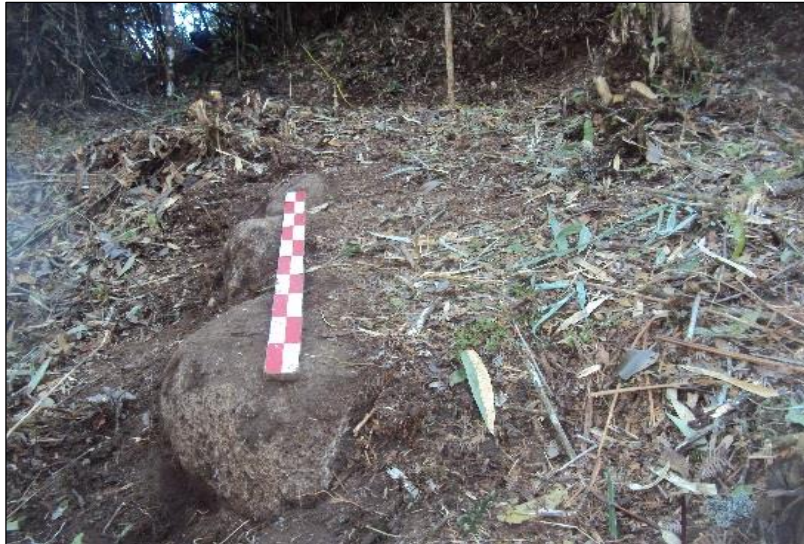
Figura 36. Vista parte del segmento de muro elaborado con material piedra granito en mal estado de conservación. Foto: Raúl Sota Flórez.
