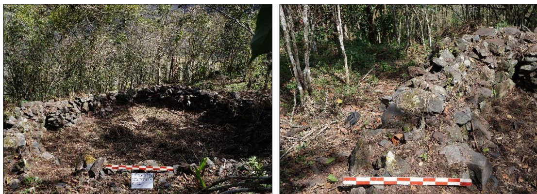
Figura 100. Fotos que muestran los aspectos constructivos de la construcción de la estructura circular. Foto: Raúl Sota Flórez.
