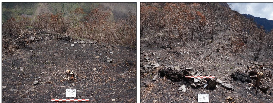
Figura 90. Fotos en las que se muestra el muro de construcción a nivel superficial totalmente colapsadas. Foto: Raúl Sota Flórez.
