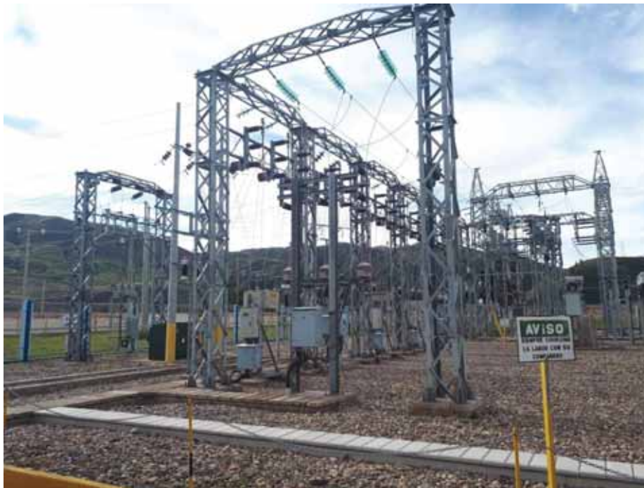
Fotografía 3. Barra de 24 kV SET Combapata
