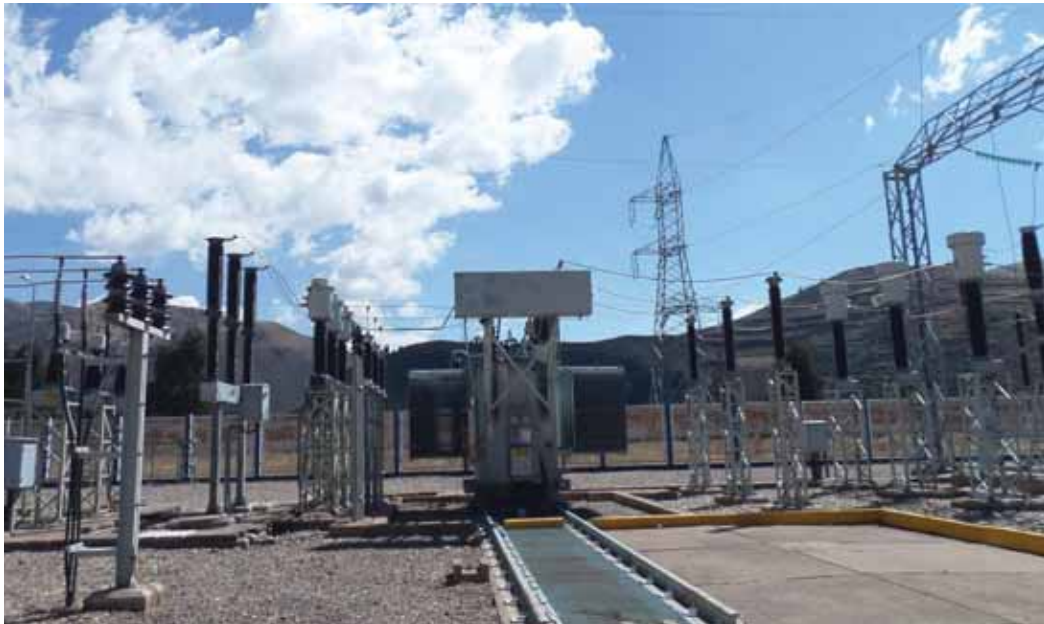
Fotografía 1. Subestación de Potencia Combapata
