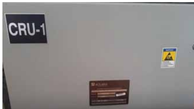
Fotografía 13. CRU imagen externa
