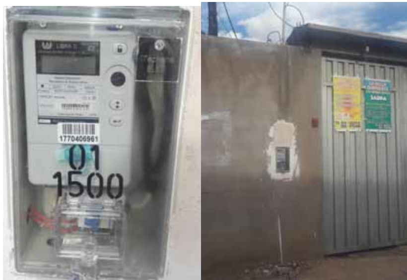
Fotografía 17. Medidor instalado en suministro 10130005818 de la Localidad de Accha distrito de Paruro
