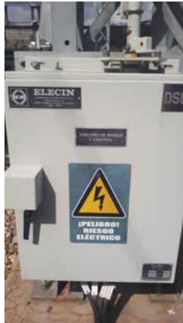
Fotografía 9. Tablero de mando de Seccionador de Línea
