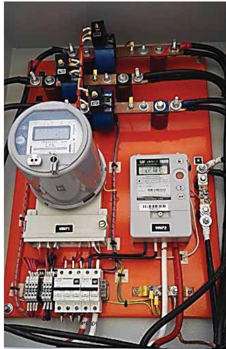
Fotografía 18. Medidor kV2c instalado en interior tablero en la SED 0040073 - Checacupe
