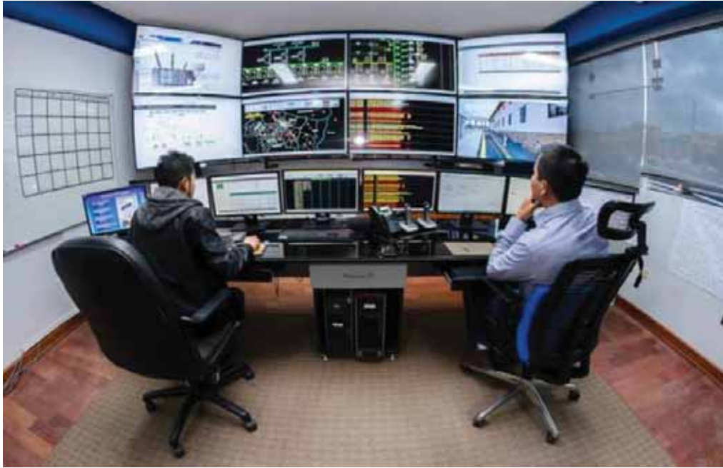
Fotografía 25. Estación de Trabajo TWACS
