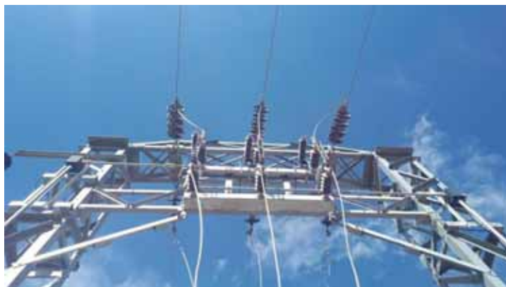
Fotografía 8. Seccionador de Línea
