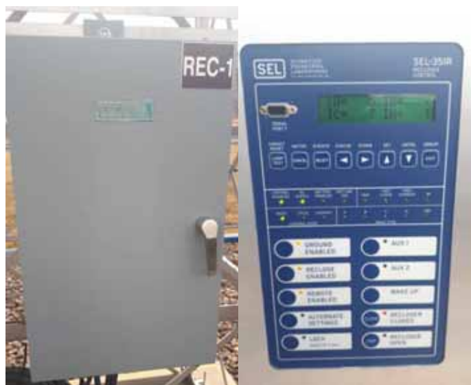
Fotografía 7. Tablero de Control y Rele SEL de Recloser
