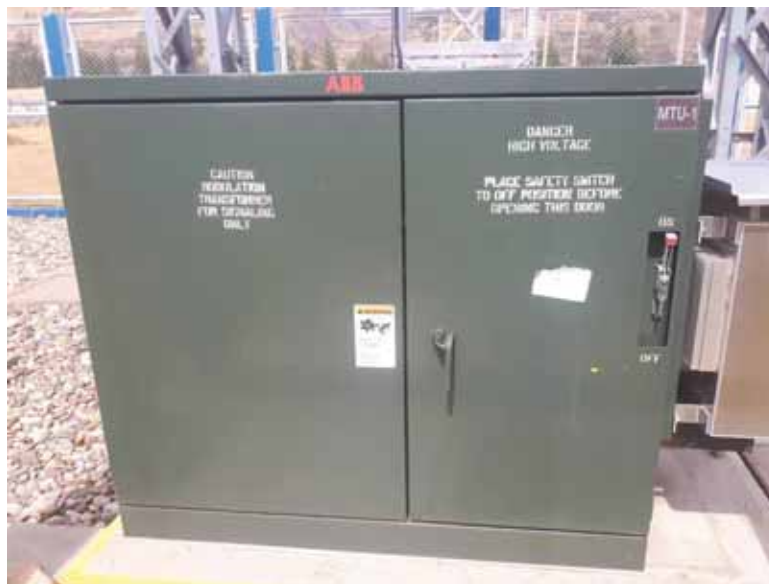
Fotografía 10. Transformador de modulación
