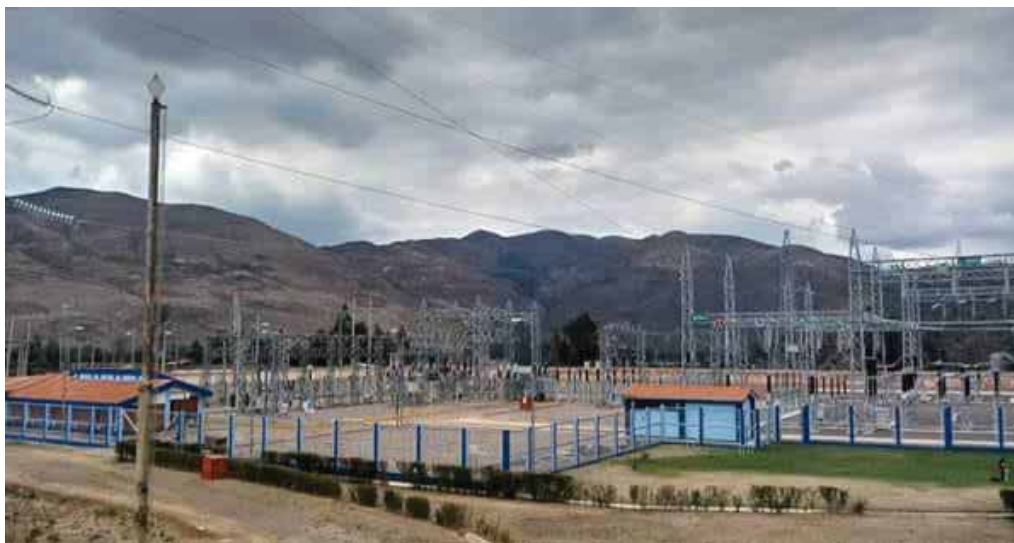
Fotografía 2. Patio de Llaves SET Combapata
