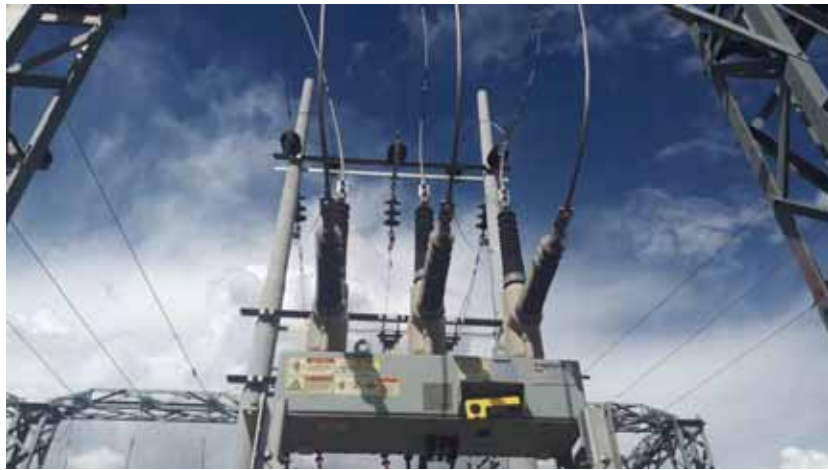
Fotografía 6. Recloser de Marca G&W
