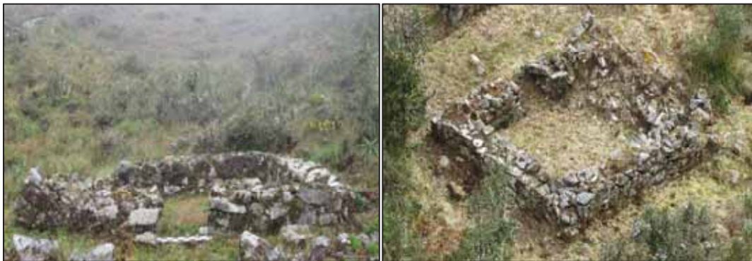
Figura 91. vease al extremo izquierdo, detalle del vano de acceso al recinto 02; a la derecha, vista del colapso de muro lateral Este.
