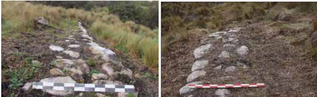
Figura 2820. Véase camino empedrado con piedras maestras laterales, en mal estado de conservación.
