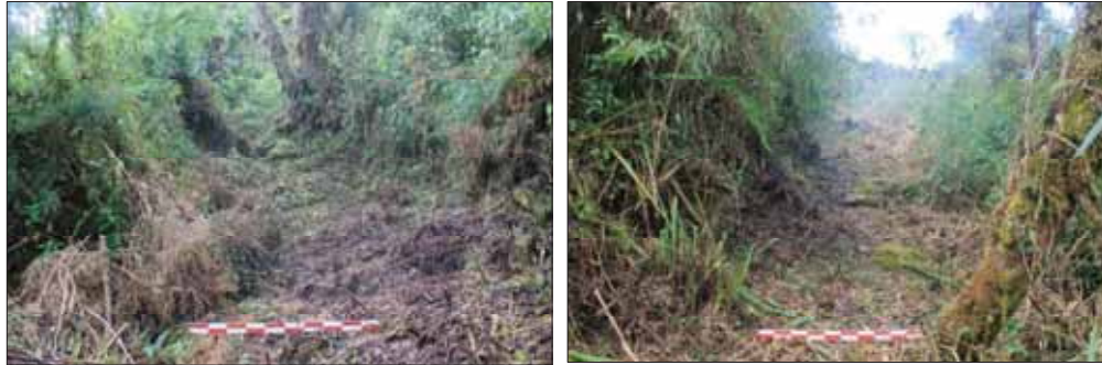
Figura 40. Camino afectado por vegetación arbustiva y arborea.
