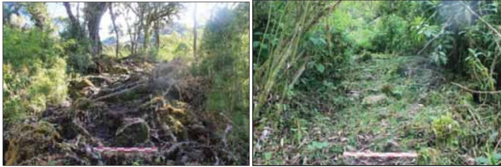
Figura 17. Al extremo izquierdo, se ve la proliferación de las raíces que afectan el camino. A la derecha, se muestran pocos indicios de la existencia de escalinatas.
