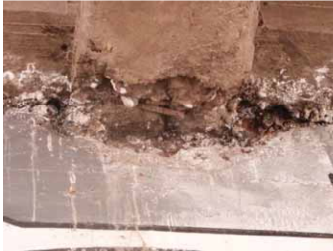
Figura 70: Desgaste del concreto, exposición del acero e infiltración. Fuente: Fotografía Propia
