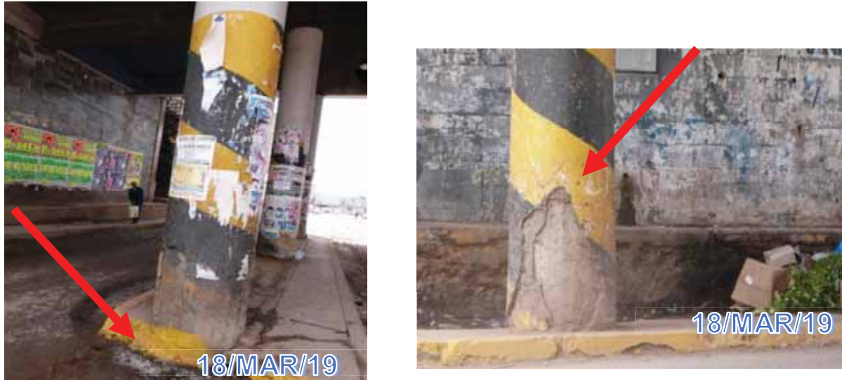
Figura 21: Infiltración y Perdida de recubrimiento en los pilares Fuente: Fotografías propias
