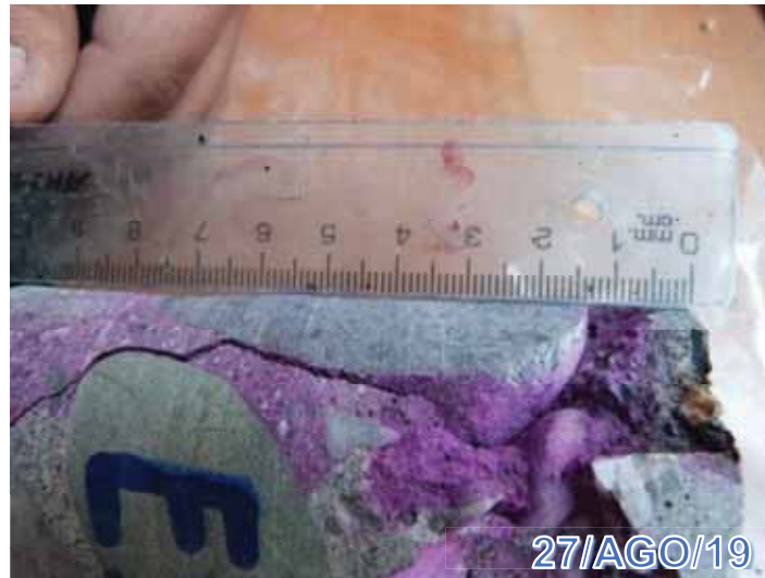
Figura 33: Muestra (E-02), carbonatación de 0.5cm Fuente: Fotografía Propia
