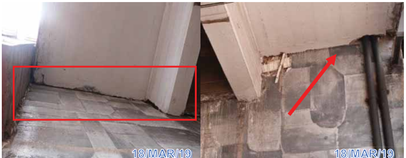
Figura 12: Fisuramiento entre losa y muro de contención
