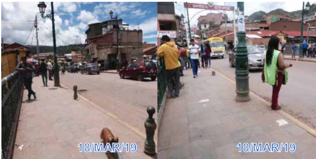
Figura 20: Estado actual de las aceras del puente. Fuente: Fotografías propias
