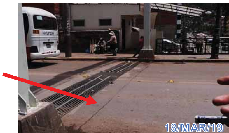
Figura 18: Fisura en el final del puente. Fuente: Fotografía propia
