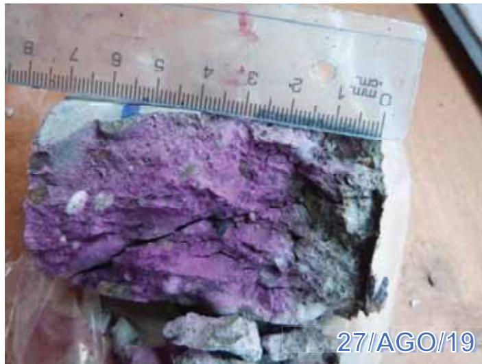
Figura 34: Muestra (E-03), carbonatación de 1cm Fuente: Fotografía Propia
