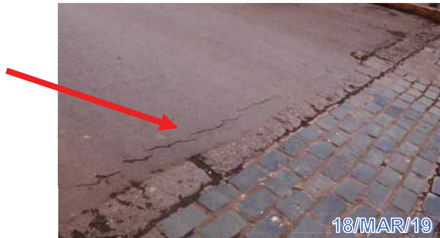
Figura 17: Fisura en el inicio del puente. Fuente: Fotografía propia
