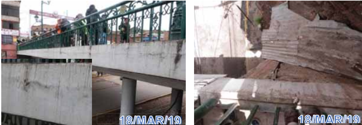
Figura 23: Fisuras del recubrimiento la Losa y Área aledaña al M.C. sin protección adecuada Fuente: Fotografías propias
