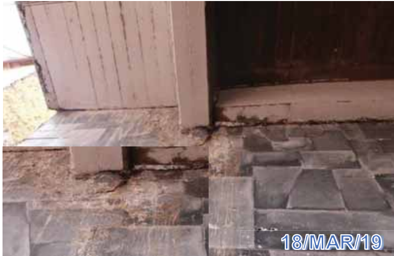
Figura 15: Desprendimiento de concreto en el M. C. (carril de subida)
