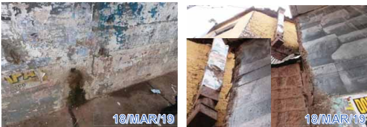
Figura 22: Mal estado de los drenajes de los M.C y Acero suelto en el M.C.
